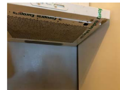
Feste på filter er defekt.
