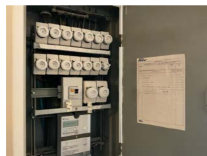
Sikringsskap i felles gang.
