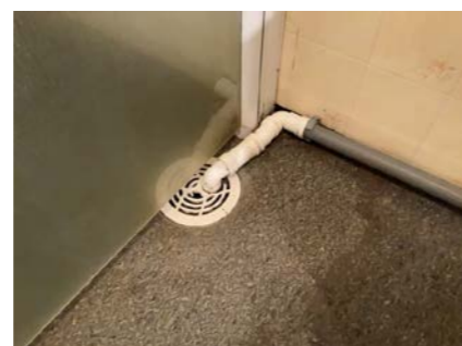
Avløp fra vaskemaskin stenger delvis for dør til dusjnisje.
