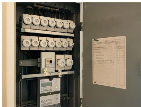
Sikringsskap i felles gang.
