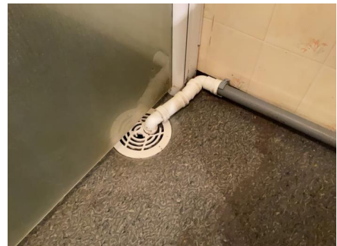
Avløp fra vaskemaskin stenger delvis for dør til dusjnische.
