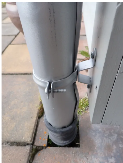
Deformasjon i nedløpsrør.
