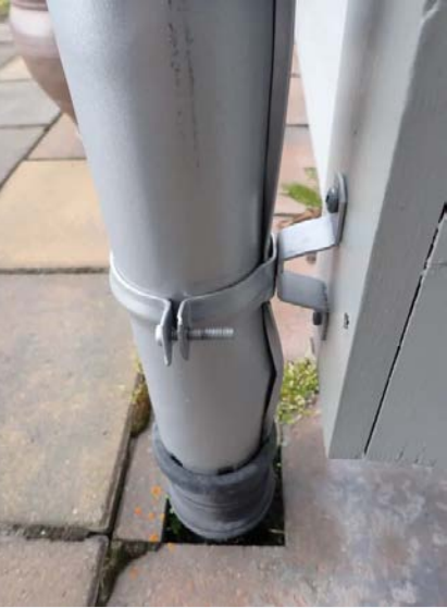
Deformasjon i nedløpsrør.
