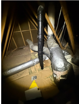
Bildet viser uisolert avløpsrør for utlufting.
