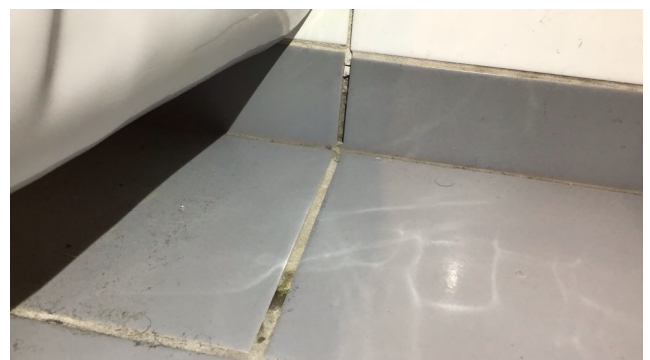
Bildet viser manglende flisfuge ved toalettet.
