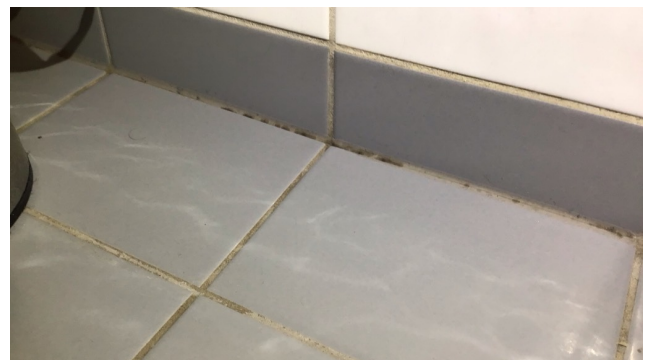
Bildet viser svertesopp i silikonfuge.
