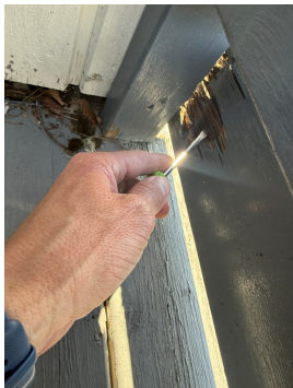
Bildet viser råte i rekkverksbord.
