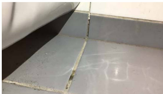
Bildet viser manglende flisfuge ved toalettet.
