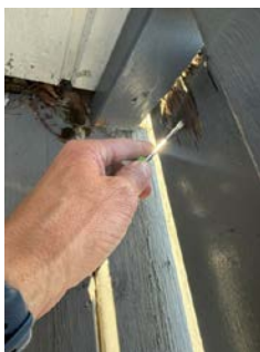
Bildet viser råte i rekkverksbord.
