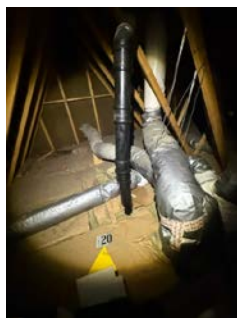
Bildet viser uisolert avløpsrør for utlufting.
