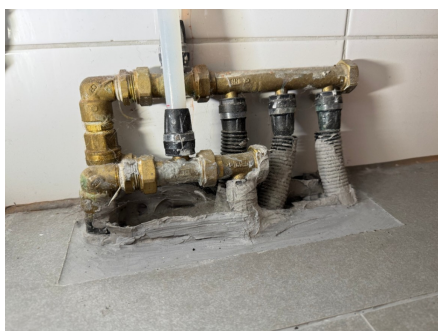
Rørgjennomføringer i gulv under servant.
