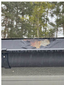
Avskalling av belegg på bordtakbeslag
