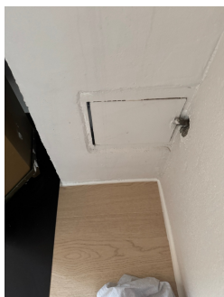
Det er ikke ildfast plate på gulv under feieluke.
