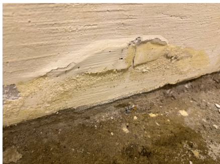
Saltutslag nederst på vegg.
