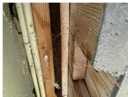
Det er ikke tilfredsstillende luftespalte i nedkant av kledning.
