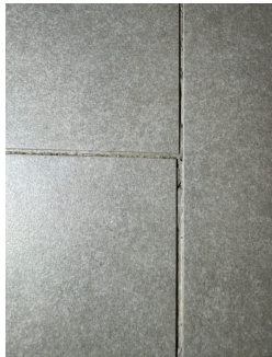
Sprekk i fuger på fliser med bom.
