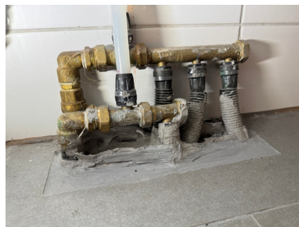
Fordelerstokk på bad.
