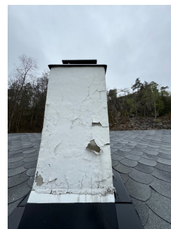
Avskalling av puss og maling på pipe over tak.
