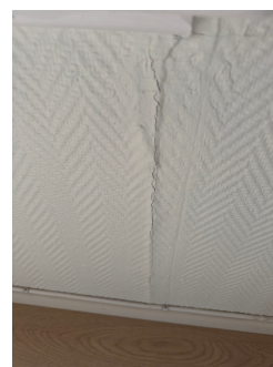
Krymp/sprekk i strie ved vindu i stuen
