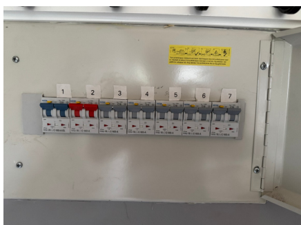
Sikringsskap i entre.
