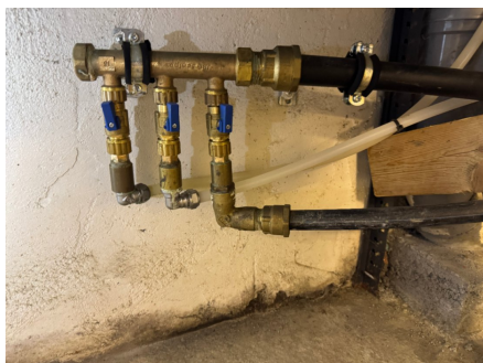
Fordelerstokk med stoppekran i underetasjen.
