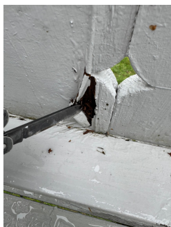
Det er råte i flere rekkverksbord.
