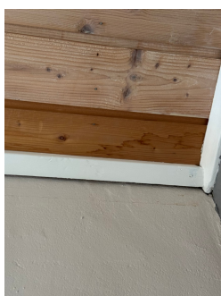
Fuktskjolder i panel i tak ved pipe.
