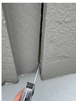
Belistning ligger helt ned til vannbrettbeslag.
