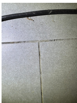
Sprekk i fuger på fliser i entre med bom.
