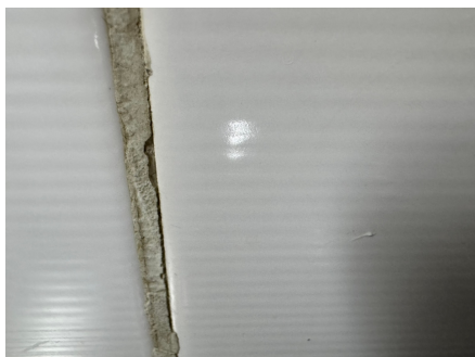
Sprekk/riss i enkelte fuger
