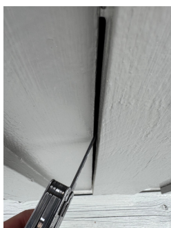
Det er flere steder overligger ikke dekker over mellomrommet mellom underliggere.
