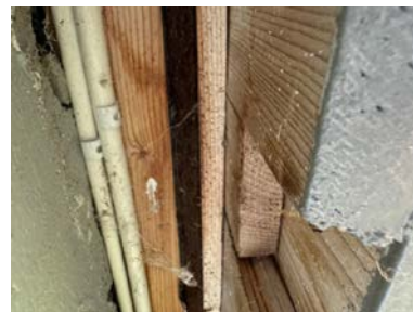
Det er ikke tilfredsstillende luftespalte i nedkant av kledning.
