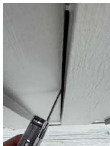
Det er flere steder overligger ikke dekker over mellomrommet mellom underligger.
