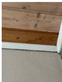
Fuktskjolder i panel i tak ved pipe.
