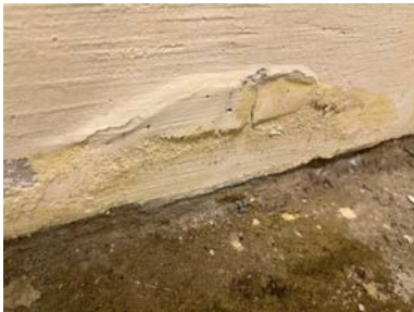
Saltutslag nederst på vegg.
