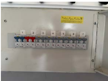
Sikringsskap i entre.
