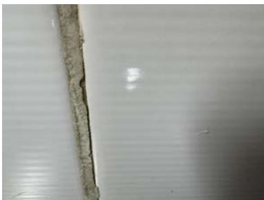
Sprekk/riss i enkelte fuger
