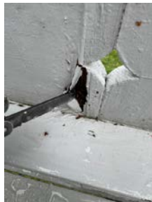
Det er råte i flere rekkverksbord.
