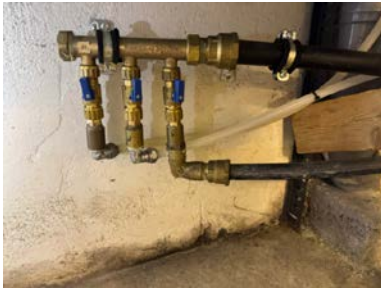
Fordelerstokk med stoppekran i underetasjen.
