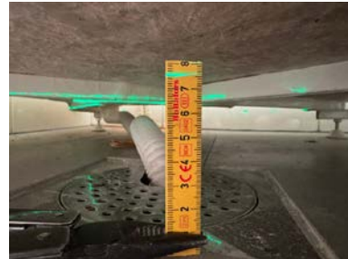
Fall mot sluk er målt med laser, målt til gulv ved sluk i dusj. 2 mm lavere enn gulv ved dør.
