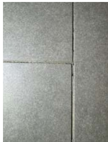
Sprekk i fuger på fliser med bom.
