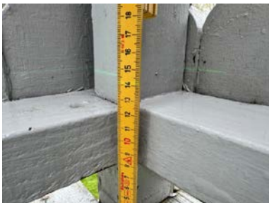
Laserstrek på 141mm ved rekkverk. Skjevhet på ca 84mm på en avstand på ca 3,5m
