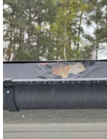
Avskalling av belegg på bordtakbeslag
