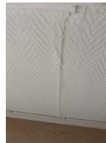
Krymp/sprekk i strie ved vindu i stuen
