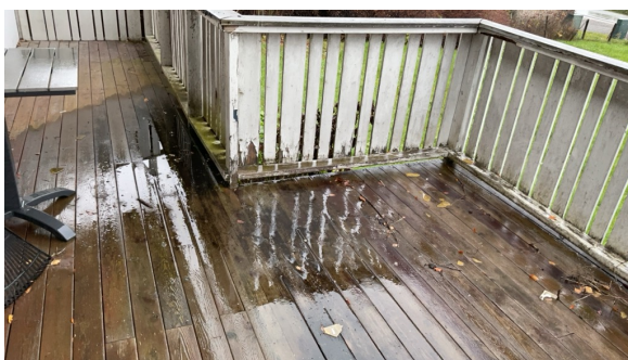
Råteskader på overflater og konstruksjon
