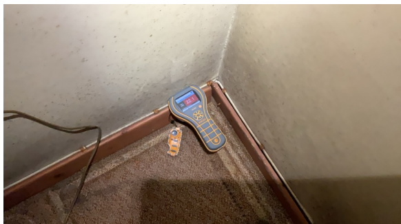
Svertesopp på vegger. Ved fuktsøk ble det registrert fukt.
