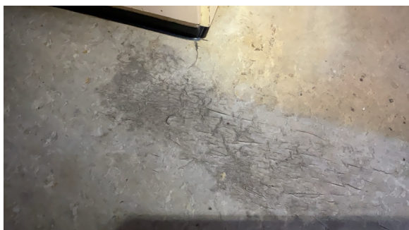
Skade/misfarging på gulv.
