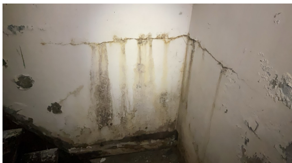
Saltutslag på vegger.
