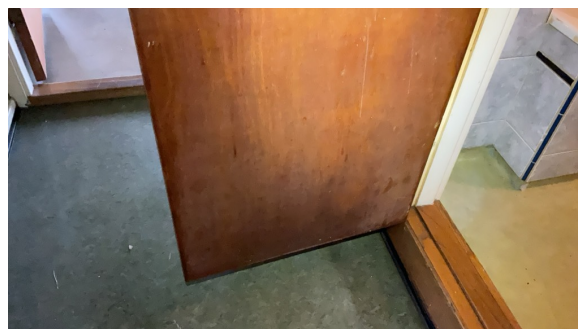
Manglende tilluft i dør.
