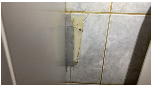
Skader på vegger.
