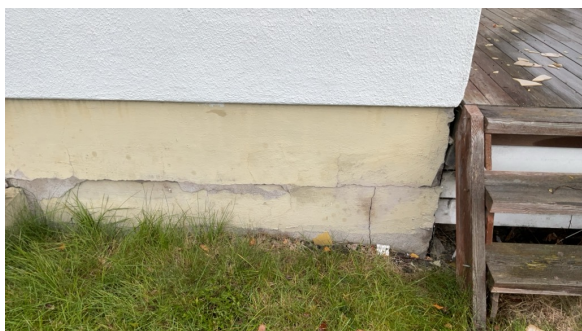
Sprekker i grunnmur.
