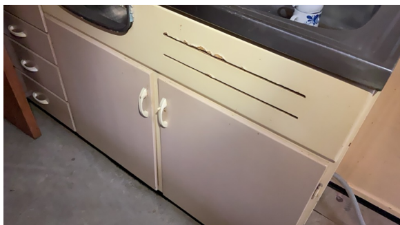
Svelling på innredning.
