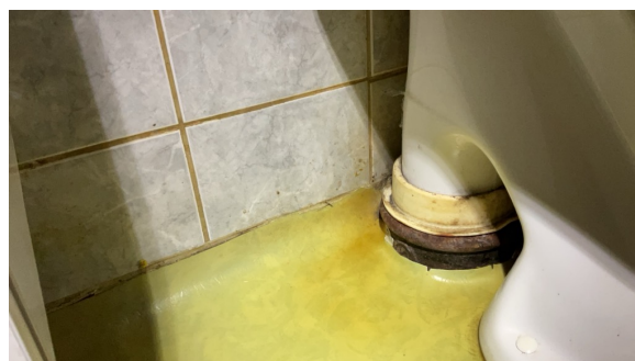
Belegg har løsnet rundt toalett.
