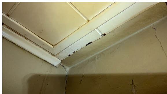
Fuktmerker rundt loftsluke.
