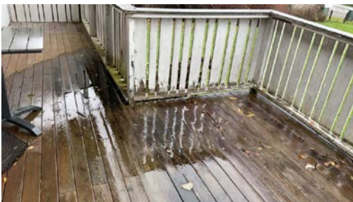
Råteskader på overflater og konstruksjon
