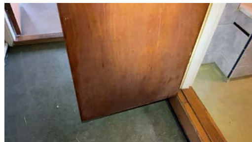
Manglende tilluft i dør.
