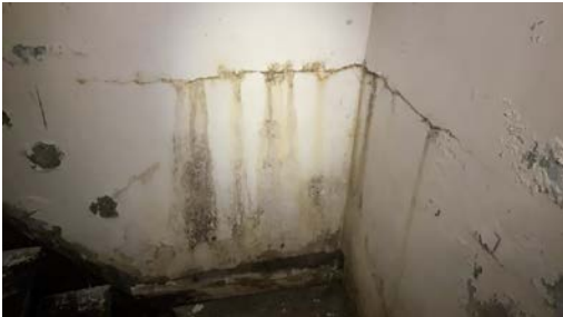
Saltutslag på vegger.
