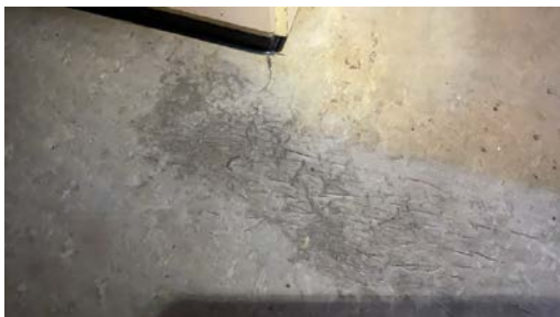
Skade/misfarging på gulv.
