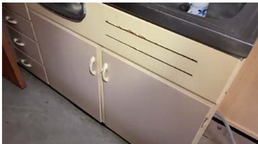
Swelling på innredning.
