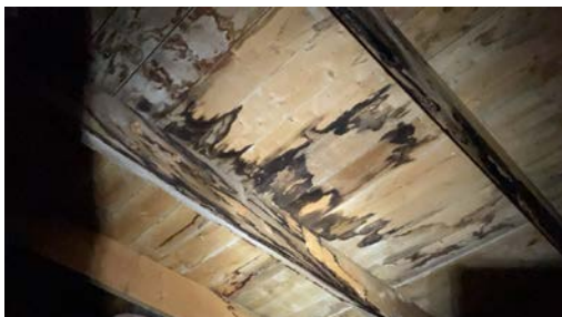
Store fuktmerker på undertak.
