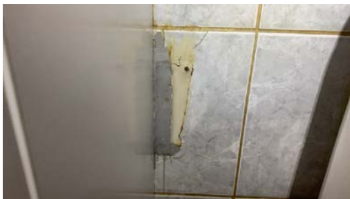
Skader på vegger.
