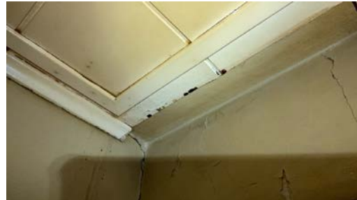
Fuktmerker rundt loftsluke.
