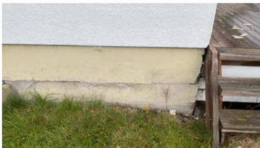
Sprekker i grunnmur.
