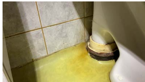
Belegg har løsnet rundt toalett.
