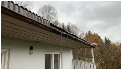
Lekkasje på takrenner og takfotbeslag mangler.
