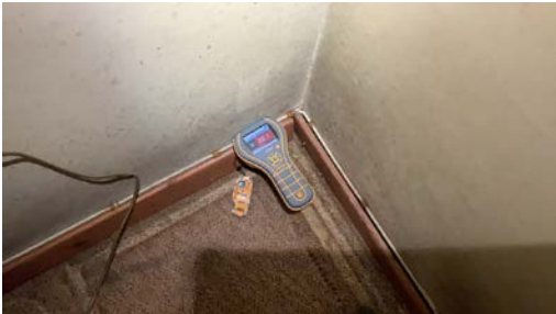
Svertesopp på vegger. Ved fuktsøk ble det registrert fukt.
