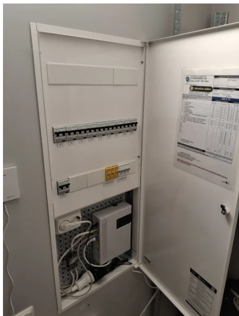
Sikringsskap er plassert på bod/teknisk rom.
