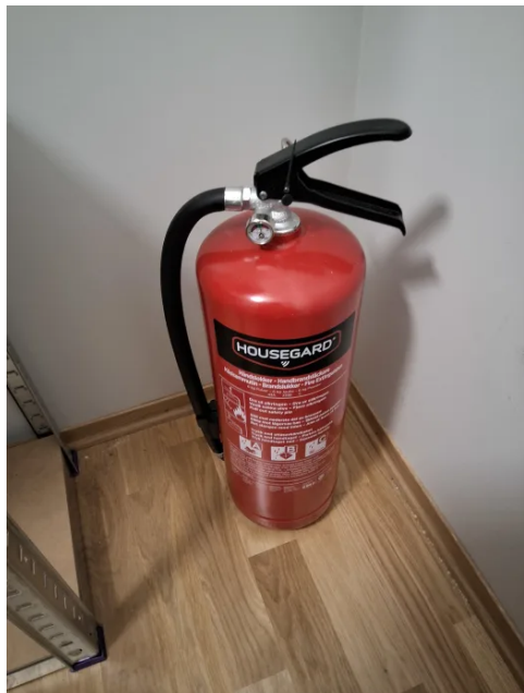
Brannslukningsapparat er plassert i teknisk rom.
