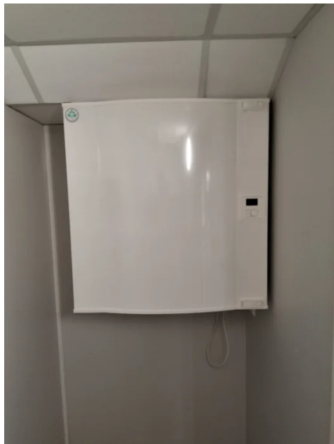
Ventilasjonsaggregat er plassert i bod/teknisk rom.
