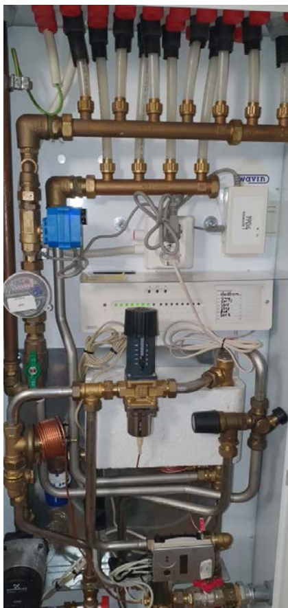
Samlestokker, vannstoppeventil og hovedstoppekraner er plassert i fordelerskap. (Selgers bilde).
