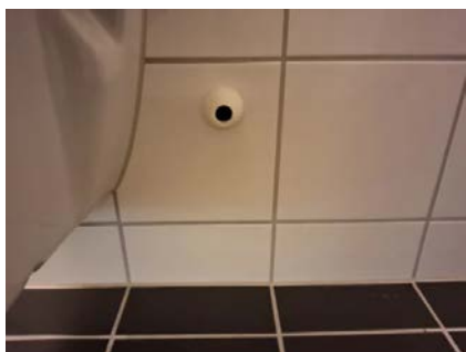
Avrenning fra innebygd sisterner.
