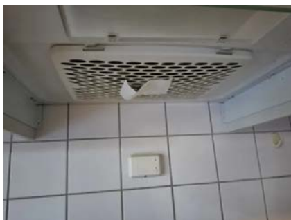
Avtrekkseffekt er testet med papir.
