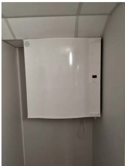
Ventilasjonsaggregat er plassert i bod/teknisk rom.
