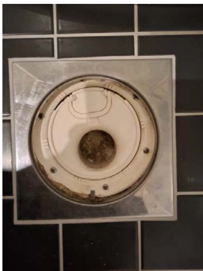
Overgang mellom sluk/membran er ikke tilgjengelig for visuell kontroll.
