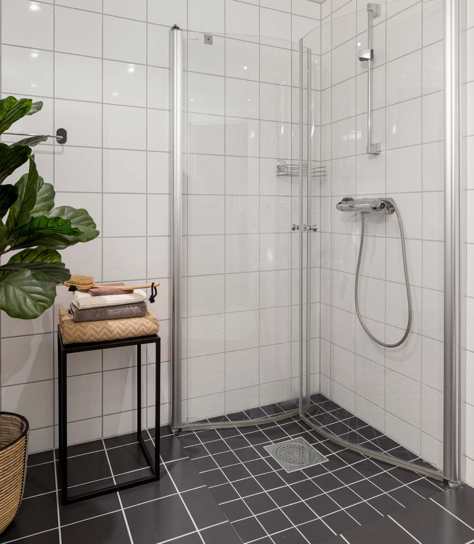
Dusjhjørne med innfellbare dusjdører og veggmontert dusjbatteri.
