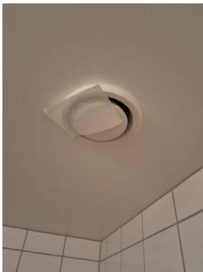
Avtrekkseffekt er testet med papir.
