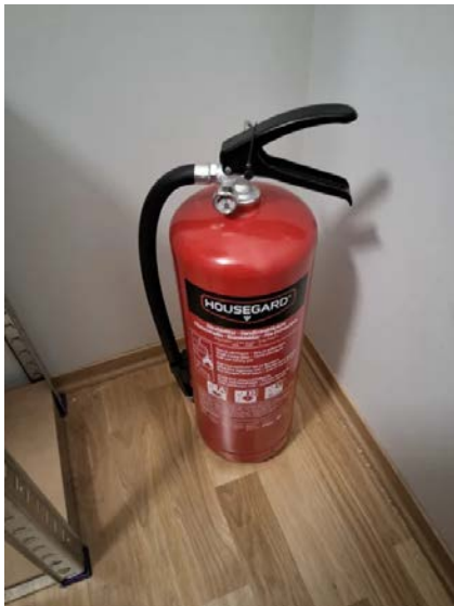
Brannslukningsapparat er plassert i teknisk rom.
