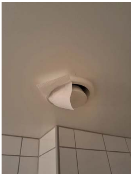
Avtrekkseffekt er testet med papir.
