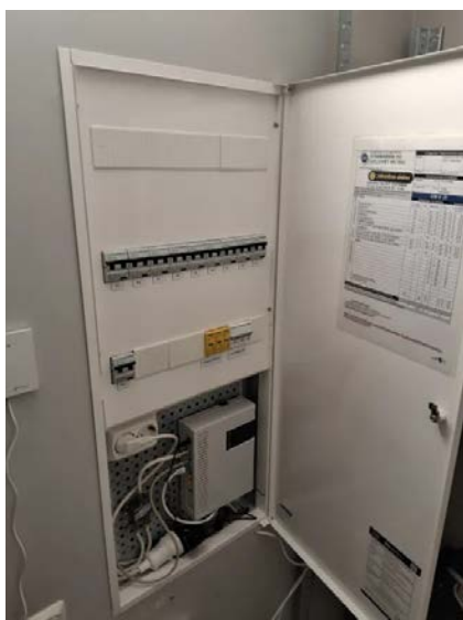
Sikringsskap er plassert på bod/teknisk rom.
