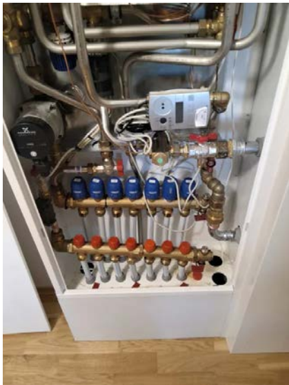
Regulatorer til vannbåren gulvvarme er plassert i fordelerskap.
