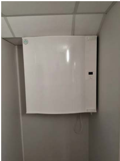
Ventilasjonsaggregat er plassert i bod/teknisk rom.
