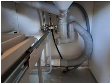
Leiligheten har synlige avløpsrør av plast.
