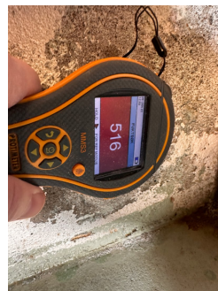
Fukt indikasjoner og saltutslag på yttervegg ved gulv i kjellerbod
