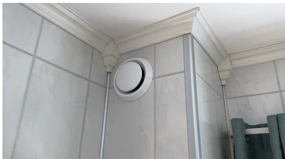
Ventil i vegg
