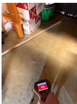
Fukt indikasjoner på gulv i kjellerbod
