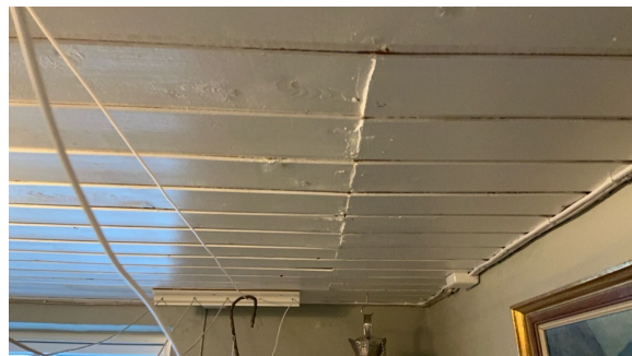
Ikke fagmessig skjøting av takpanel
