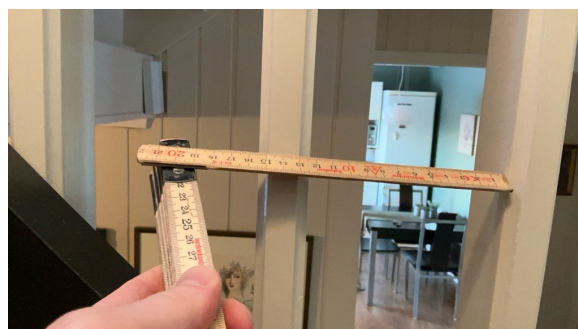
Åpninger for store i rekkverk på trapp
