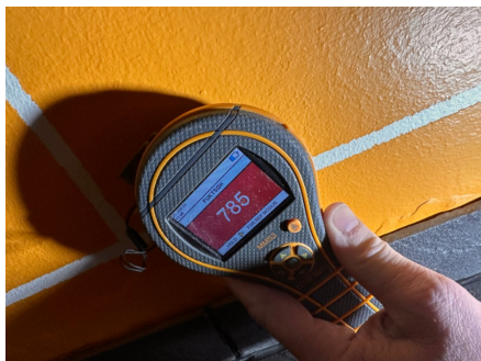
Fukt indikasjoner og noe maling som slipper på bærevegg i kjeller
