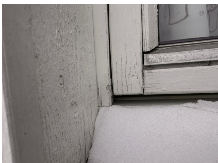
Litt værslitasje utvendig på vindu
