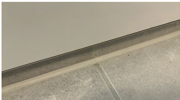
Mangler silikon mellom våtromsplate og bunnlist
