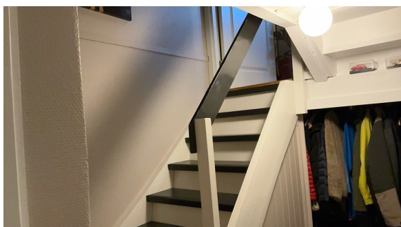
Manglende håndløper, og for stor åpning i rekkverk
