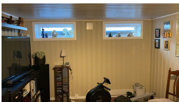
Vinduene i kjellerstuen er for høyt oppe på vegg, samt at de er for små for rømning.
