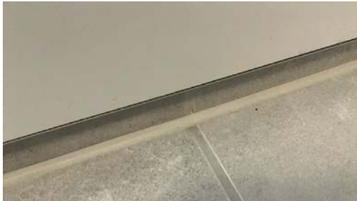
Mangler silikon mellom våtromsplate og bunnlist
