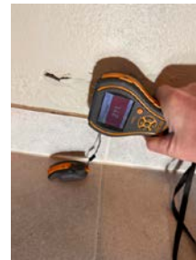
Fukt indikasjoner og noe maling som slipper på yttervegg i vaskerom
