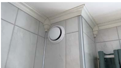
Ventil i vegg
