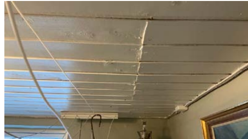
Ikke fagmessig skjøting av takpanel
