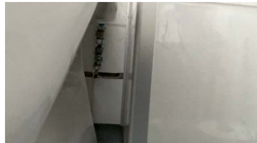
Hull i baderomsplate ved toalett
