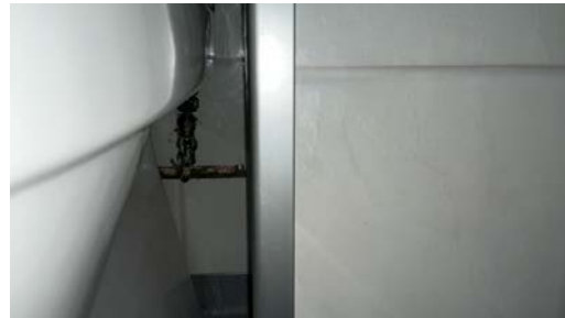
Mangelfull/feil utførelse rundt rørgjennomføringer
