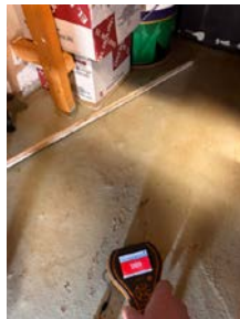
Fukt indikasjoner på gulv i kjellerbod
