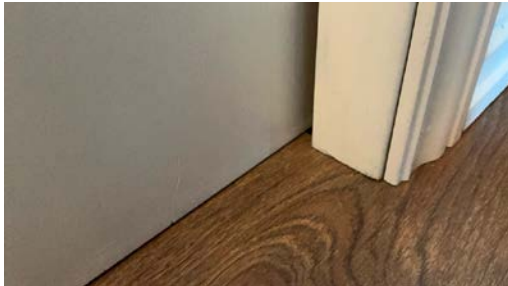
Skyvedør mangler styring i bunn, samt tar litt i gulvet
