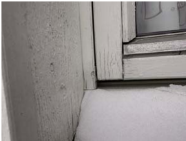
Litt værsiltasje utvendig på vindu
