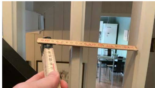
Åpninger for store i rekkverk på trapp
