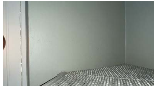
Riss i pussen på pipen
