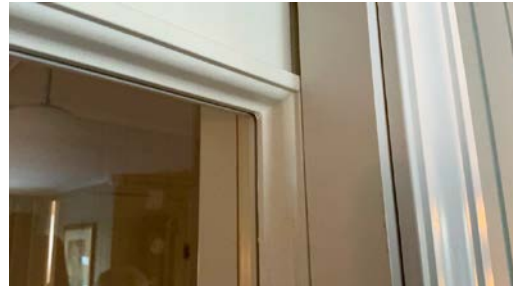
Skyvedør tar i karm ved åpning og lukking
