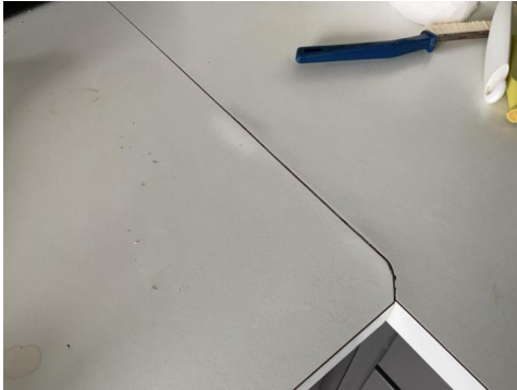
Litt svelling i plateskjøt på benkeplate.
