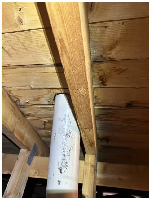
Viser fuktskjolder ved takkonstruksjonen.
