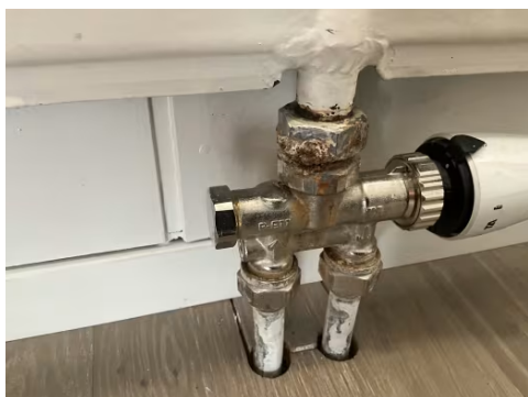
Det registreres rust og irr på koblinger.
