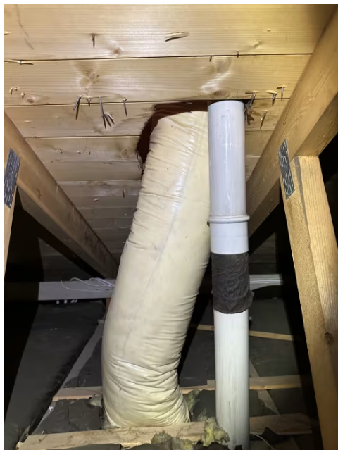
Viser fuktskjolder og synlige spiker igjennom undertak.
