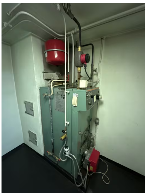
Viser oljefyranlegg plassert i kjeller.
