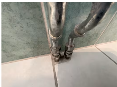
Viser manglende mansjetter ved rørgjennomføringer. Lokalt utbedret med silikon.
