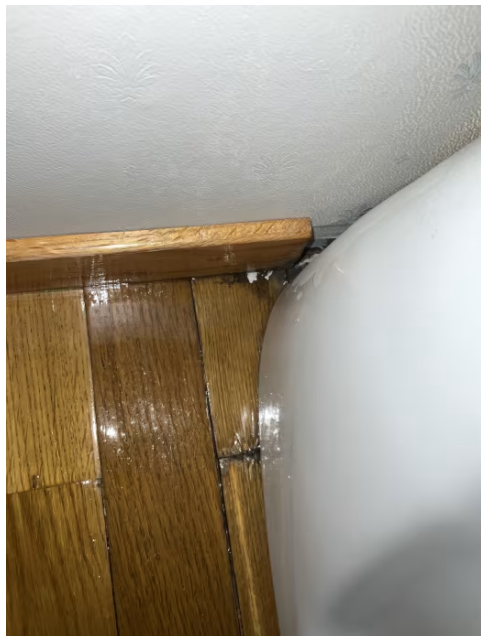
Det registreres fuksjolder bak toalett.
