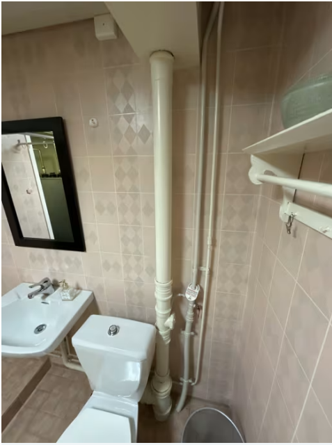
Viser avløpsrør på bad i kjeller. Fremstår noe dårlig festet.
