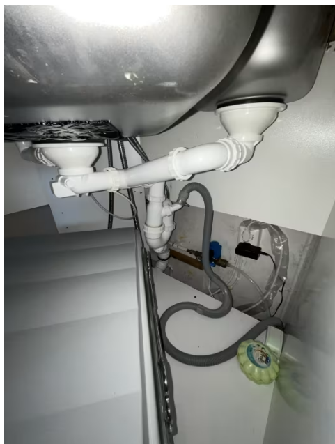
Viser vann og avløpsinstallasjoner under kum.
