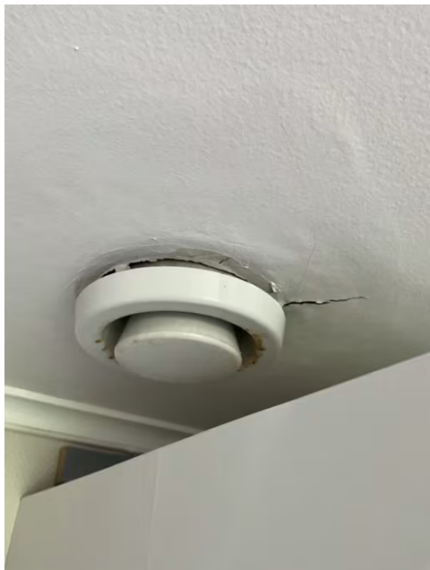
Viser sprekke og fuktskjolder ved takventil. Ingen forhøyde verdier ble målt.
