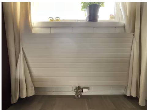
Viser eksempel på radiator montert i stue.
