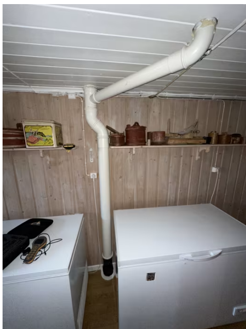
Viser avløpsrør i gang i kjeller.
