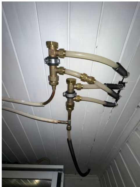
Viser åpen rørfordeling i kjeller.
