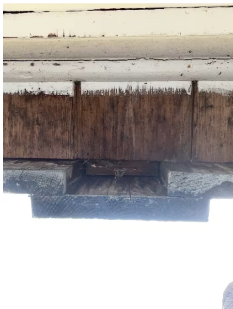
Det er benyttet klosser som musesperre bak kledning. Dette har medført stedvis redusert lufting. Endeveden anbefales mettet med beis/maling.
