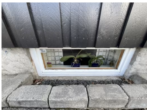
Det er ikke etablert beslag under bunnkarm på vinduer montert i mur.
