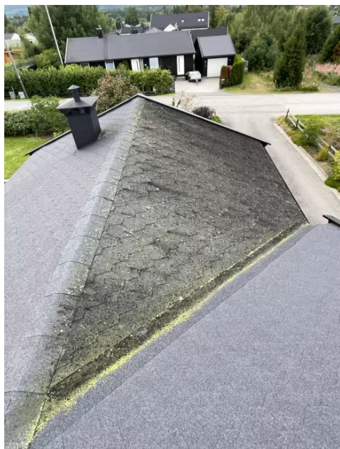
Det registreres mosegroing på taket.
