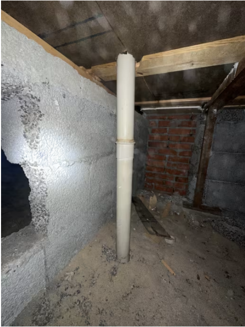
Avløpsrør i krypkjeller må isoleres.
