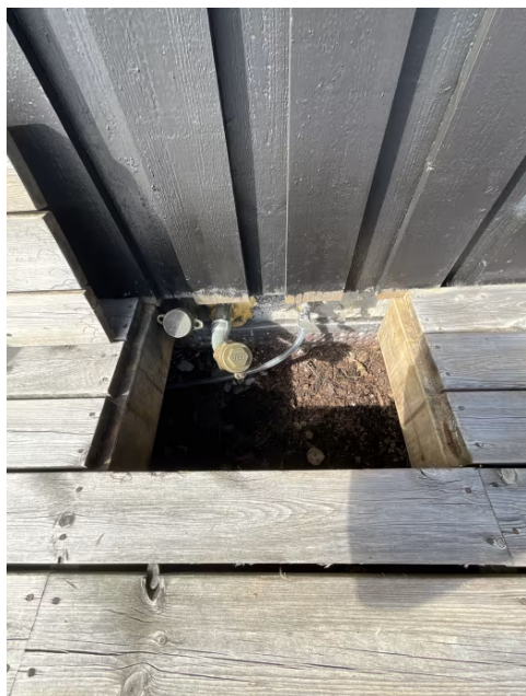
Viser utekran og påfylling av oljetanker under luke ved platting.
