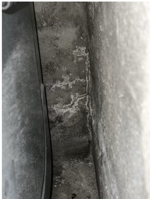
Viser saltutslag på vegg i fyrrom.
