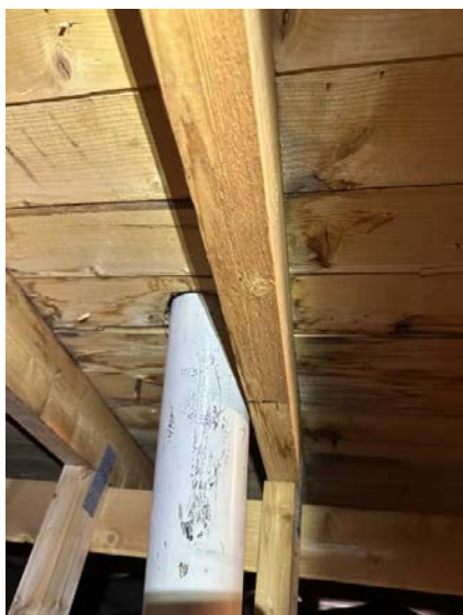
Viser fuktskjolder ved takkonstruksjonen.
