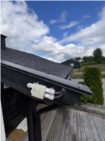
Det er etablert varmekabler i takrenne mot øst.
