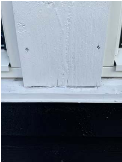
Liten/ingen avstand mellom trepanel og beslag, fare for fuktopptrekk.
