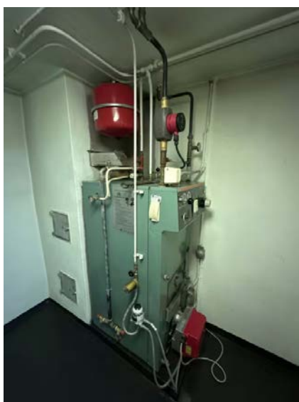
Viser oljefyranlegg plassert i kjeller.
