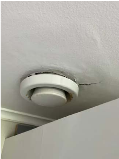
Viser sprekk og fuktskjolder ved takventil. Ingen forhøyde verdier ble målt.
