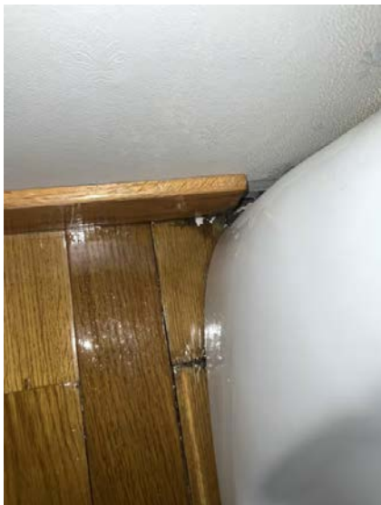
Det registreres fuksjolder bak toalett.
