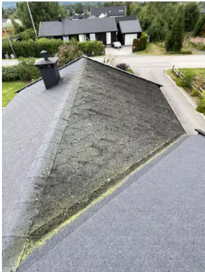
Det registreres mosegroing på taket.
