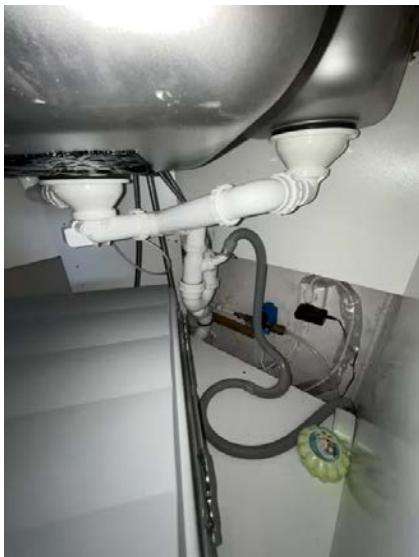
Viser vann og avløpsinstallasjoner under kum.
