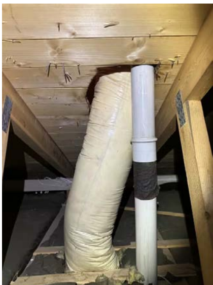
Viser fuktskjolder og synlige spiker igjennom undertak.
