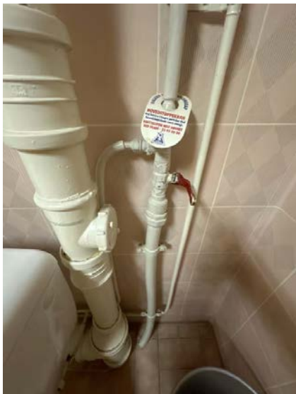
Viser vanninntak og hovedstoppekran.
