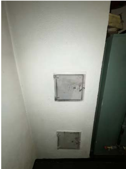
Viser sotluker i kjeller.
