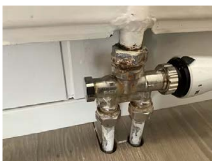
Det registreres rust og irr på koblinger.
