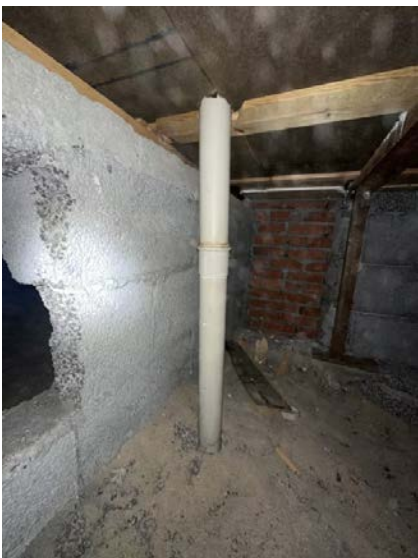
Avløpsrør i krypkjeller må isoleres.
