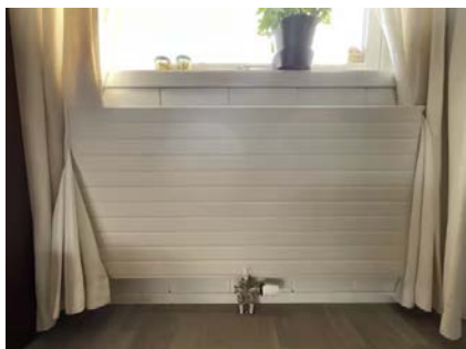
Viser eksempel på radiator montert i stue.
