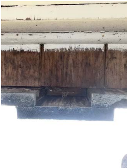
Det er benyttet klosser som musesperre bak kledning. Dette har medført stedvis redusert lufting. Endeveden anbefales mettet med beis/maling.
