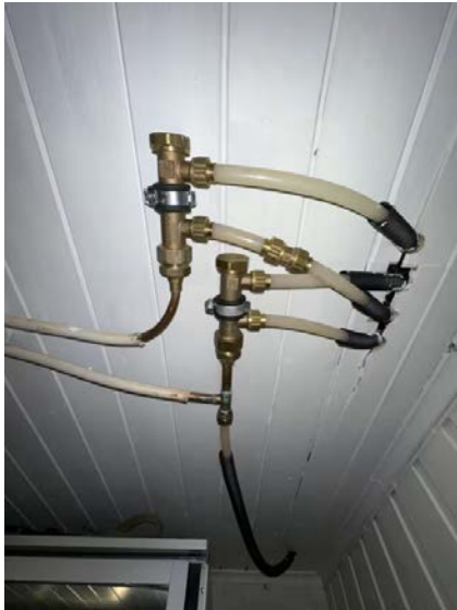
Viser åpen rørfordeling i kjeller.
