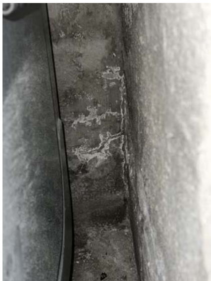
Viser saltutslag på vegg i fyrrom.
