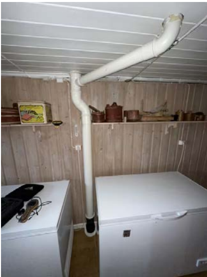
Viser avløpsrør i gang i kjeller.
