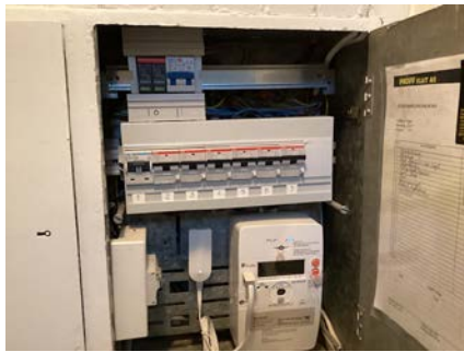
Bilde av sikringskap
