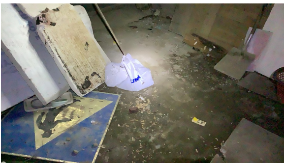
Fuktopptrekk i gulv
