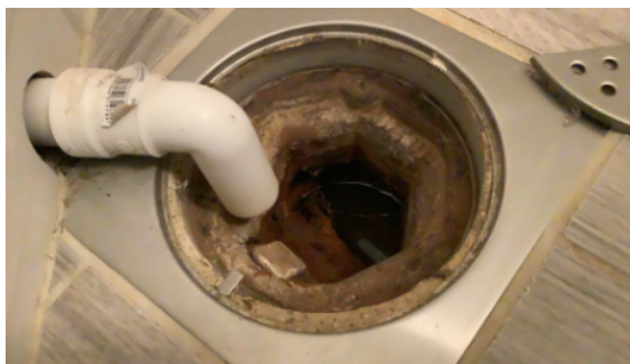
Eldre støpejernssluk på gulvet. Det er laget et lite tilførselsluk fra dusnisje som renner opp i dette.
