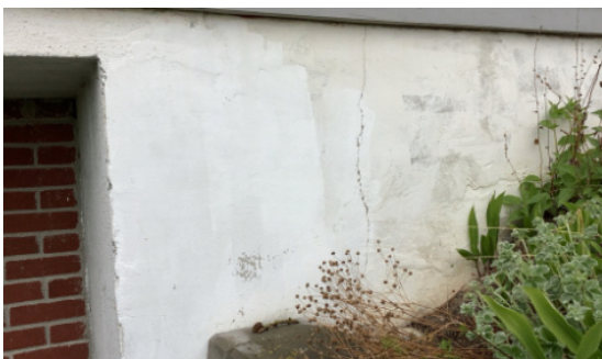
Det er registrert rissprekker i mur.
