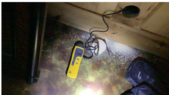
jeg målte tørre verdier nederst i yttervegg mot bunnsvill.
