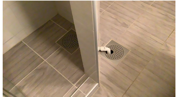
Ikke anbefalt slukløsning.
