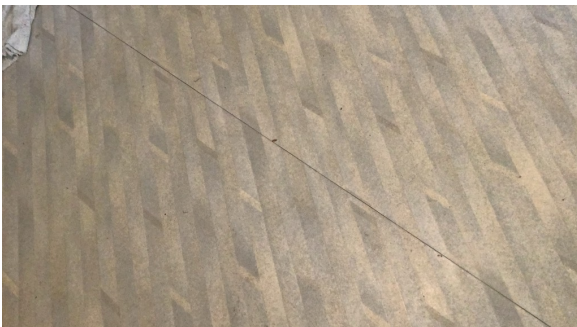
Synlig skjøt i belegg på kjøkken.
