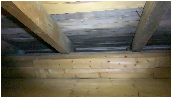
Kondensmerker på undertak i taktro.
