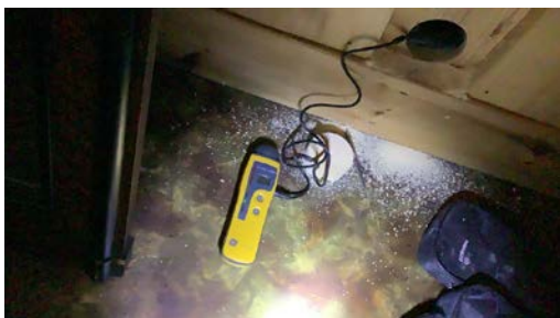
jeg målte tørre verdier nederst i yttervegg mot bunnsvill.
