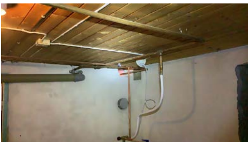
Vannrør av kobber.
