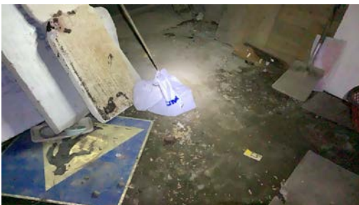
Fuktopptrekk i gulv
