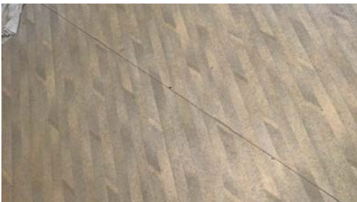
Synlig skjøt i belegg på kjøkken.
