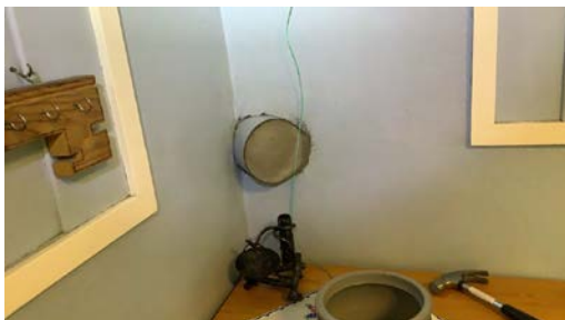
Pipehull, stålrør bør fjernes og mures igjen.
