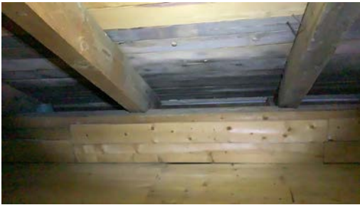
Kondensmerker på undertak i taktro.
