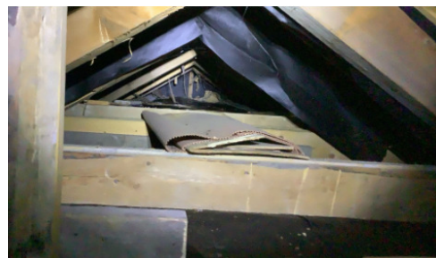
Begrenset tilgang på møneloft. Møneloftet er ikke isolert.
