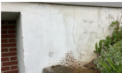
Det er registrert rissprekker i mur.
