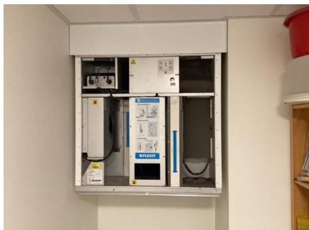
Ventilasjonsenhet på bod.
