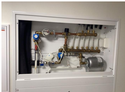
Hovedstoppekran lokalisert i fordelersskap på bod.
