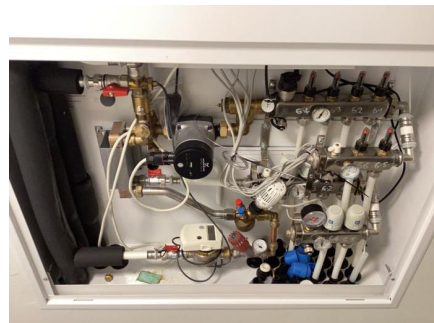
Fordelersskap på bod.
