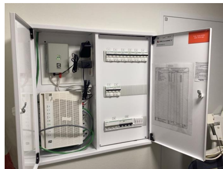
Sikringskap på bod.
