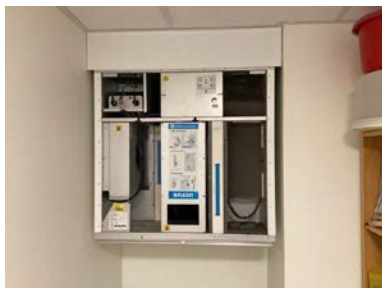
Ventilasjonsenhet på bod.
