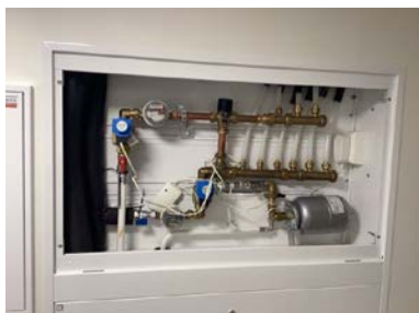
Hovedstoppekran lokalisert i fordelersskap på bod.
