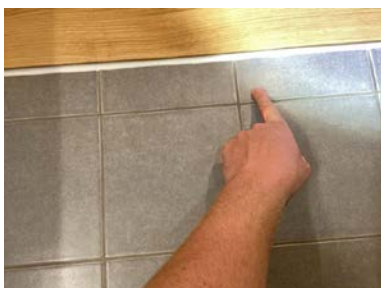
Bom i fliser registrert ved terskel ved dør.
