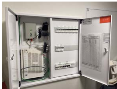
Sikringskap på bod.
