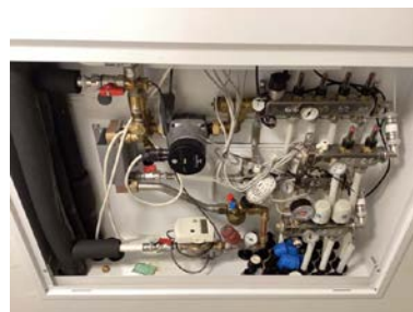
Fordelersskap på bod.
