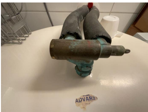
Irr på blandeventil i topp av bereder.
