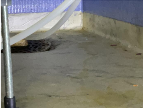
Sluk under badekar, begrenset besiktiget grunnet vanskelig tilkomst.
