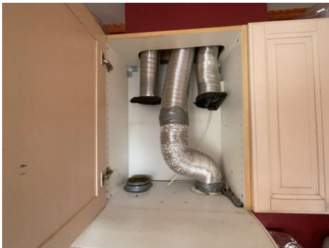
Bilde fra kjøkkenventilator.
