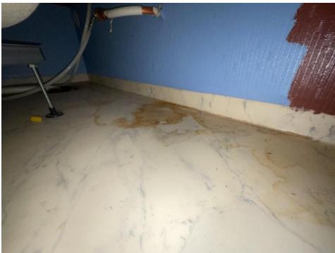
Merker på gulv viser tidligere vannansamling grunnet motfall på gulv.
