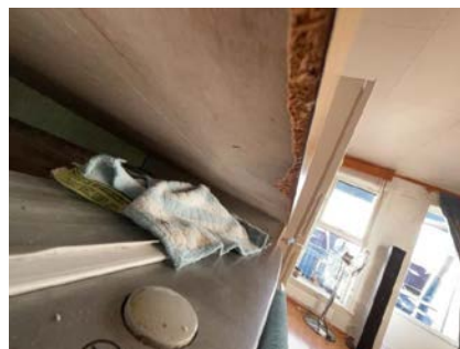
Det er ikke montert dampbeskyttelse i underkant av benkeplate over oppvaskmaskin.
