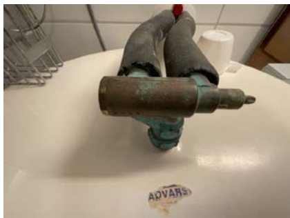
Irr på blandeventil i topp av bereder.
