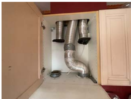
Bilde fra kjøkkenventilator.
