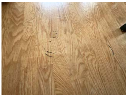
Enkelte småskader i belegg på gulv i kjøkken.
