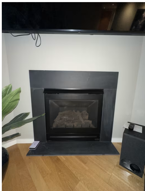
Viser gasspeis montert i stue.
