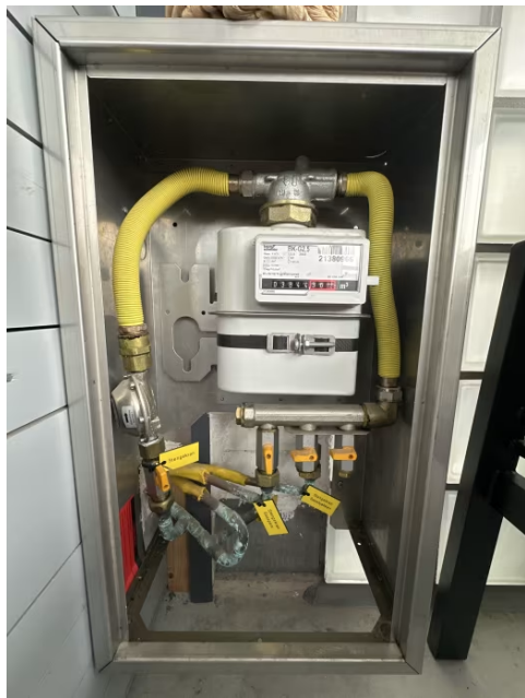
Viser metallkasse ved innglasset balkong for gassforsyning til gasspeis i stue samt måler for avlesning av forbruk.
