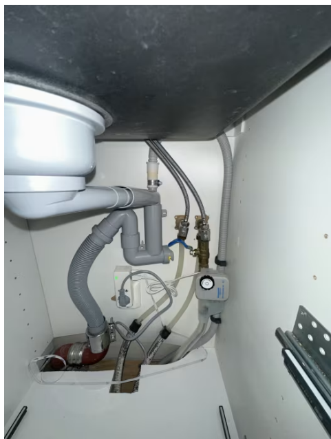
Viser vann og avløpsinstallasjoner under kum.
