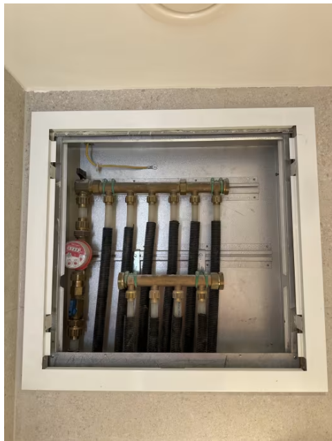
Viser rør i rør system fra fordelerskap plassert på bad og frem til sanitærinstallasjoner på baderom og kjøkken. Hovedstoppekran i skap.
