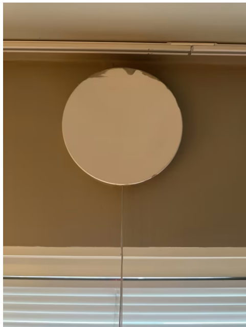
Det registreres maling på veggventiler.
