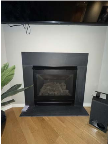
Viser gasspeis montert i stue.
