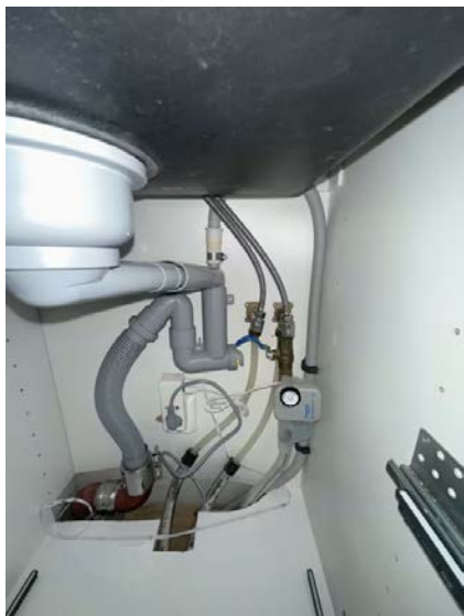
Viser vann og avløpsinstallasjoner under kum.
