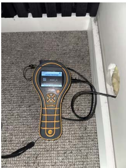
Det er foretatt hulltaking med 73 mm hullbor fra tilstøtende rom (soverom). Undersøkelsen viser ingen tegn til skader eller fukt i konstruksjonen.
