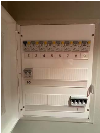
Viser innfelt sikringskapp med jordfeilautomater plassert i omkleddingsrom.
