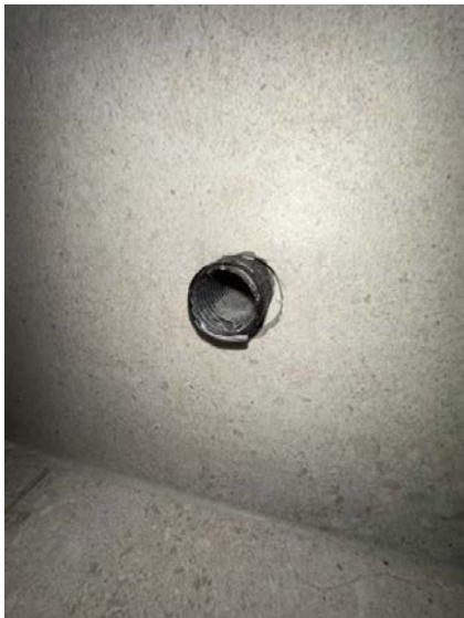
Det er ikke synlig tettesjikt rundt rørføring i vegg
