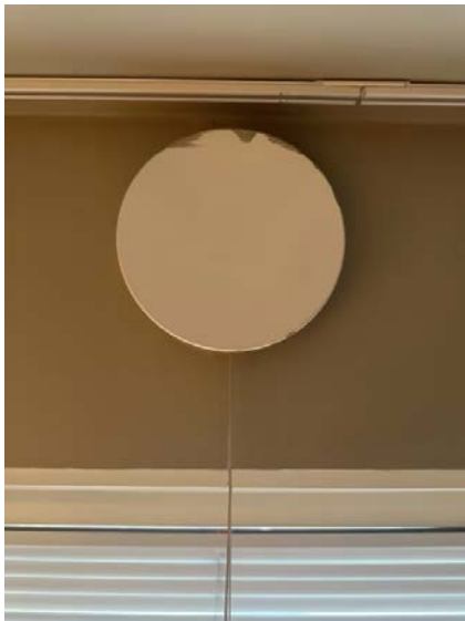
Det registreres maling på veggventiler.
