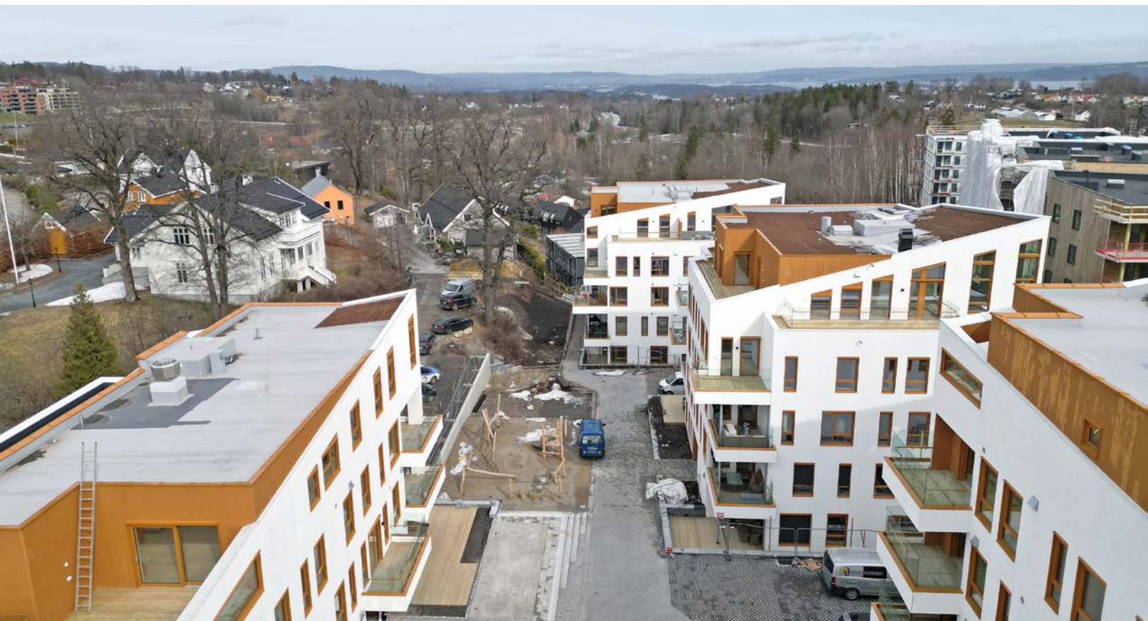
Fellesarealene er under konstruksjon, men det hyggelige torgets konturer er allerede synlige.
