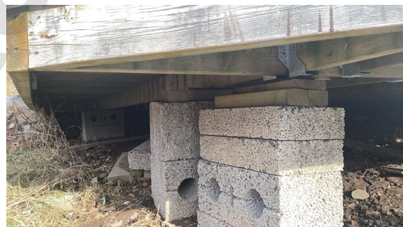
Manglende håndverksmessig utførelse på deler av arbeid.
