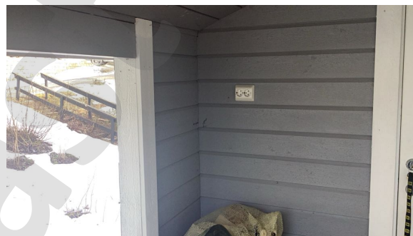
Det er ikke lokk på utvendige stikkontakter.
