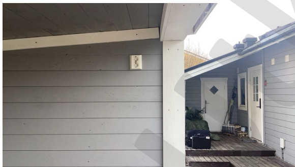
Det er ikke lokk på utvendige stikkontakter.
