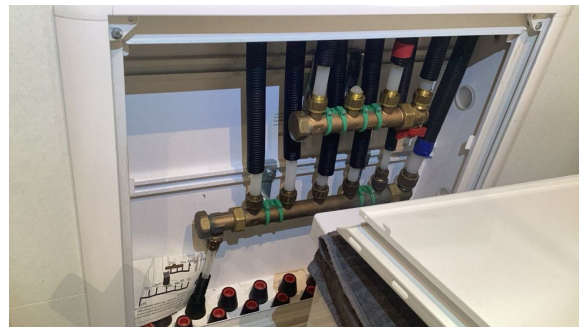
Fordelersskap på bad.
