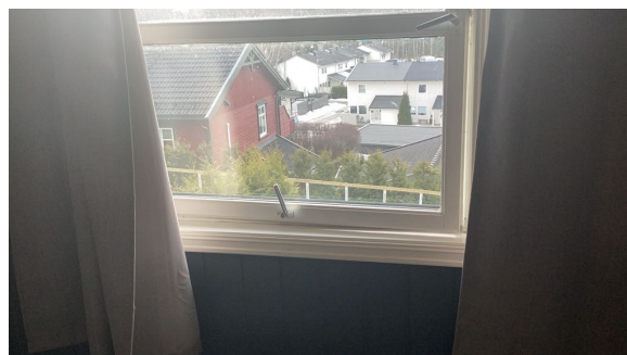
Vindu på soverom er vanskelig og lukke.
