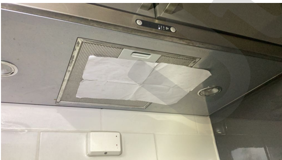
Ved test av avtrekksvifte som beskrevet i NS3600, fungerte viften som tiltenkt.
