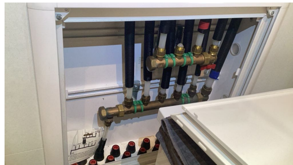
Fordelerskap på bad.
