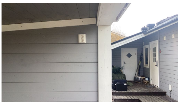
Det er ikke lokk på utvendige stikkontakter.
