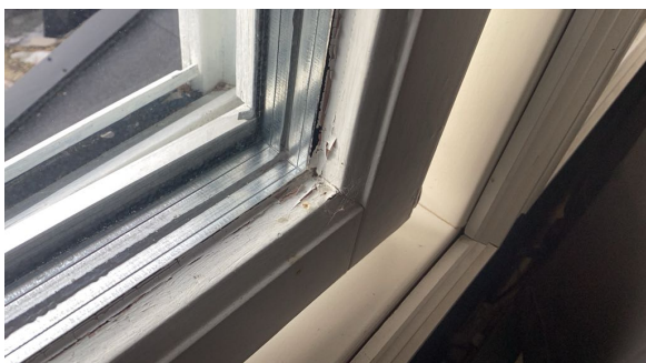
Kondensmerker på enkelte vinduer.
