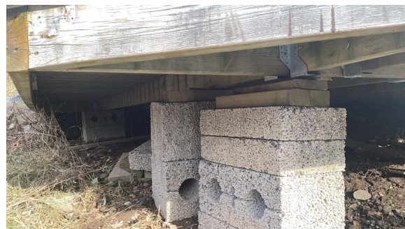
Manglende håndverksmessig utførelse på deler av arbeid.
