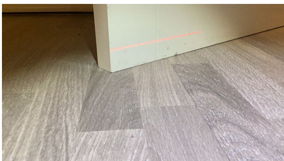
Dørblad til soverom tar i gulv.
