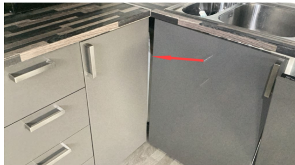
Det er ikke montert foring i hjørnet.
