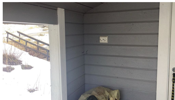
Det er ikke lokk på utvendige stikkontakter.
