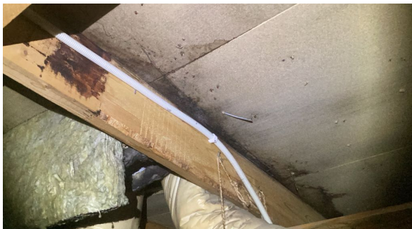
Misfarging på undertak.
