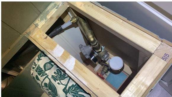
Stoppekran på kontor/soverom.
