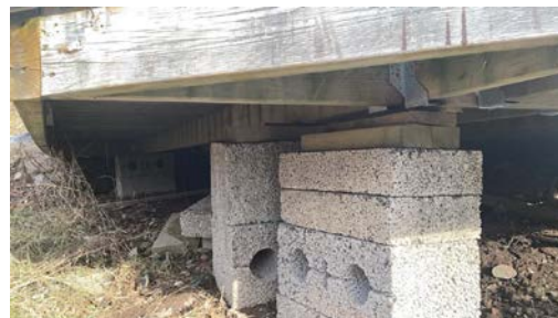
Manglende håndverksmessig utførelse på deler av arbeid.
