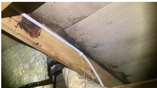
Misfarging på undertak.
