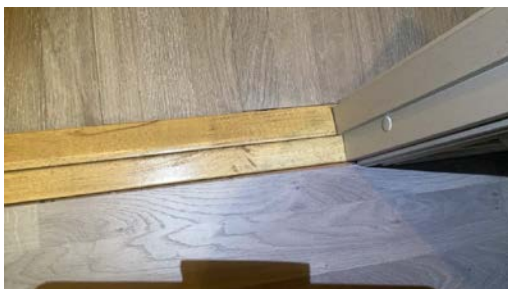
Manglende list mot terskel.
