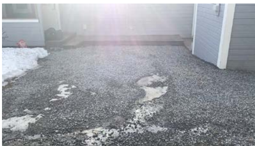
Bildet viser fall inn mot boligen.
