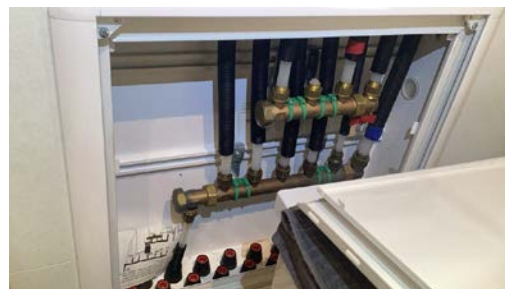
Fordelersskap på bad.
