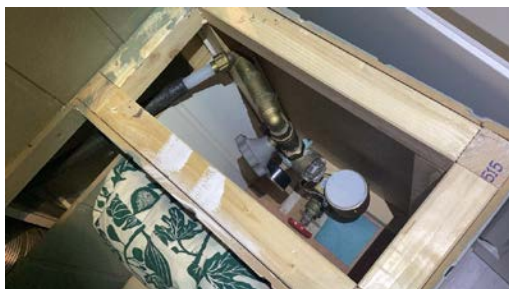
Stoppekran på kontor/soverom.
