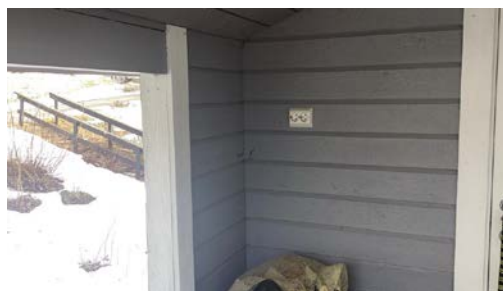
Det er ikke lokk på utvendige stikkontakter.
