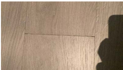
Laminatskjøter har glipper enkelte steder.
