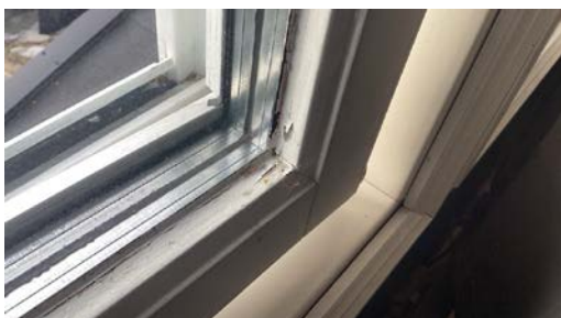
Kondensmerker på enkelte vinduer.
