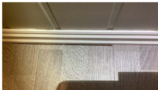
Gulv ikke ført under gulvlist.
