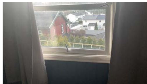
Vindu på soverom er vanskelig og lukke.
