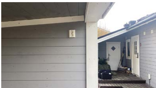
Det er ikke lokk på utvendige stikkontakter.
