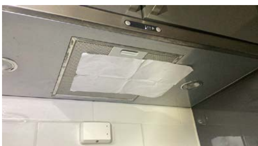
Ved test av avtrekksvifte som beskrevet i NS3600, fungerte viften som tiltenkt.
