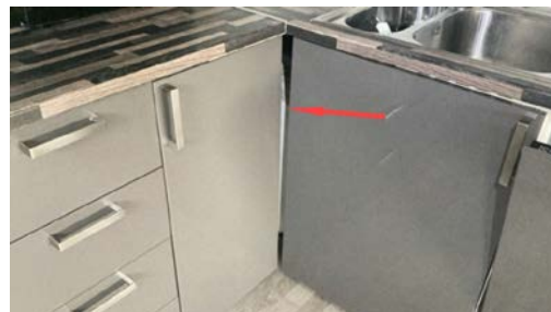
Det er ikke montert foring i hjørnet.
