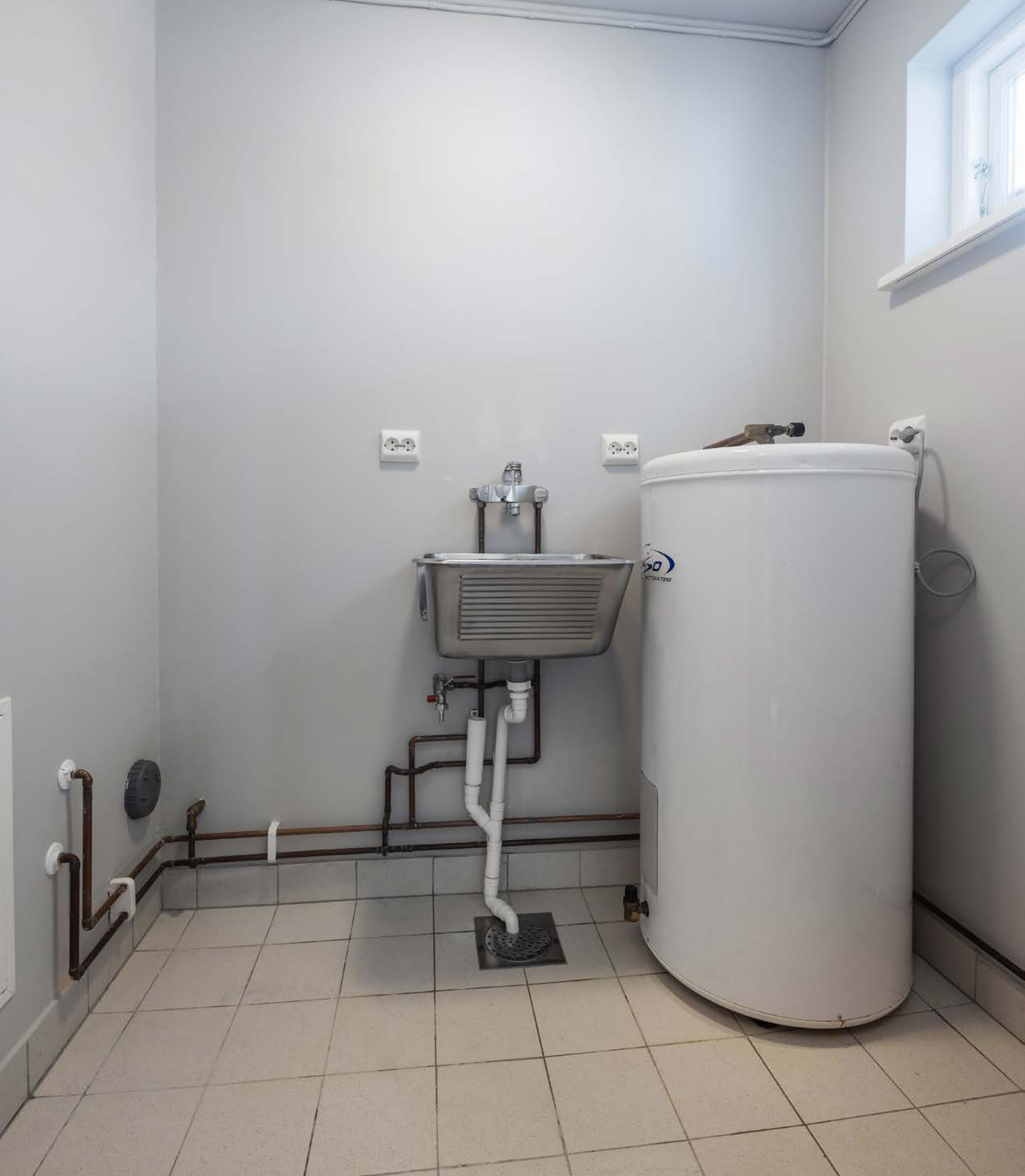
Meget praktisk vaskerom med flislagt gulv med gulvvarme, samt opplegg for vaskemaskin og skyllekum.
