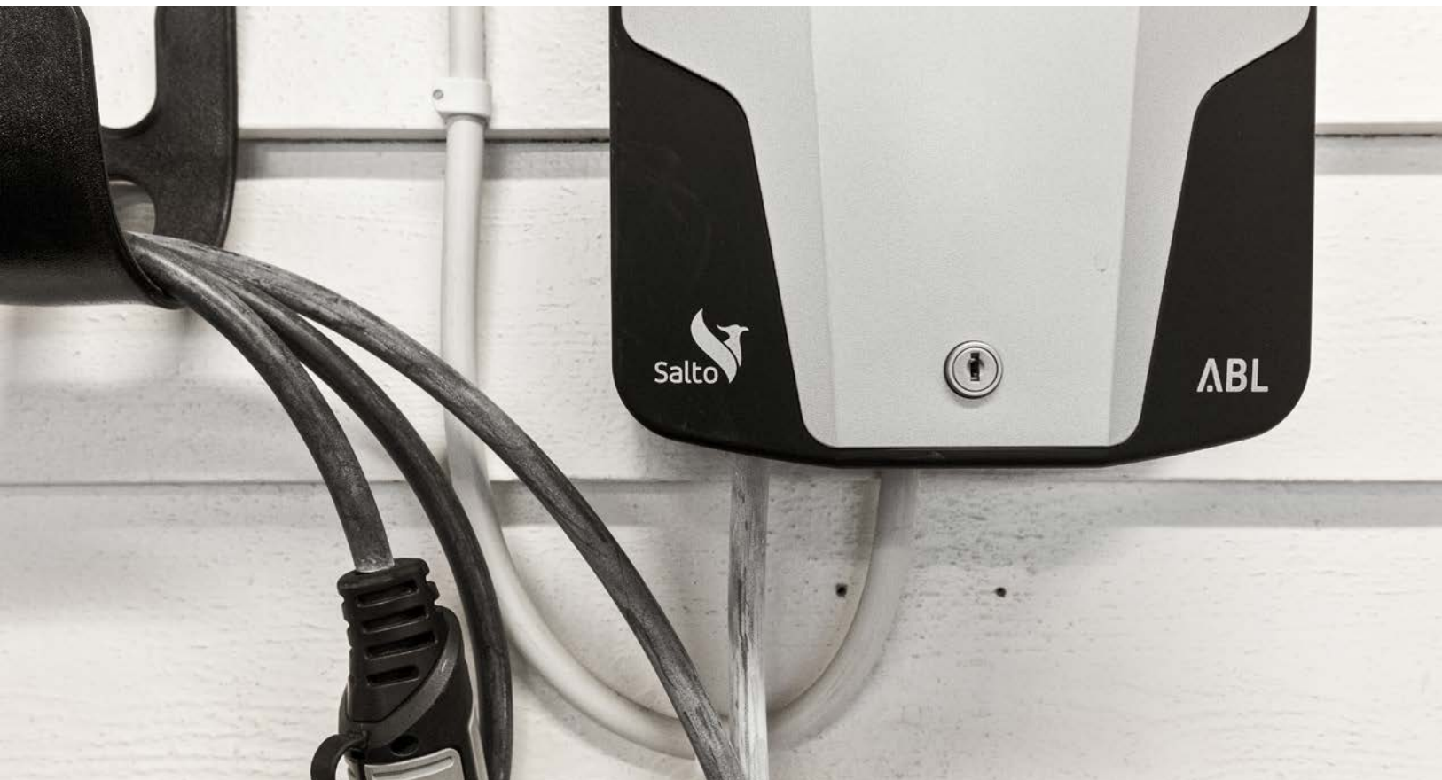
Salto 553 El-bil lader er montert på garasjevegg.
