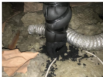
synlig mus som har soist på isolasjon for avløpsrør til lufting.
