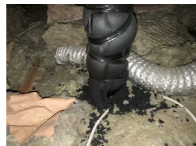
synlig mus som har soist på isolasjon for avløpsrør ttil luffting.
