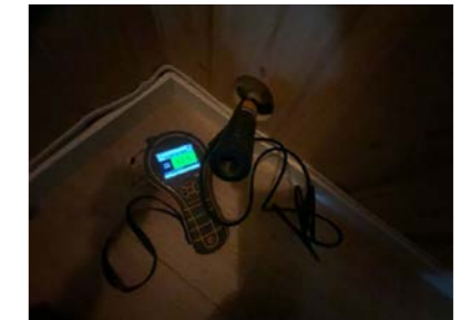
Det ble ikke målt fukt i utforet vegg på ander siden av vegg i peisstue.
