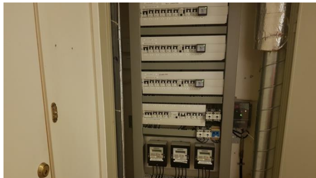
Kontroll av el-skap.
