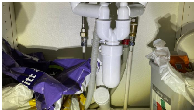
Vannrør av kobber, innvendig hovedstoppekran ble ikke lokalisert ved befarings.
