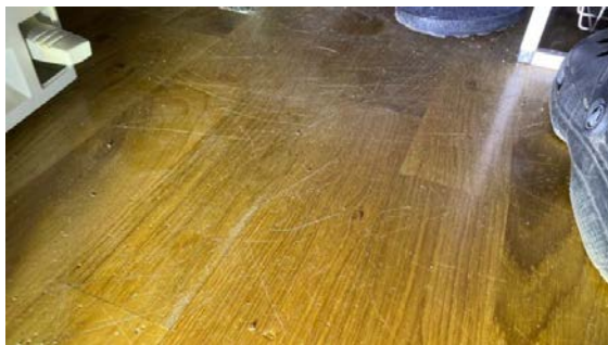
Det er en del hakk/riper i parkett.
