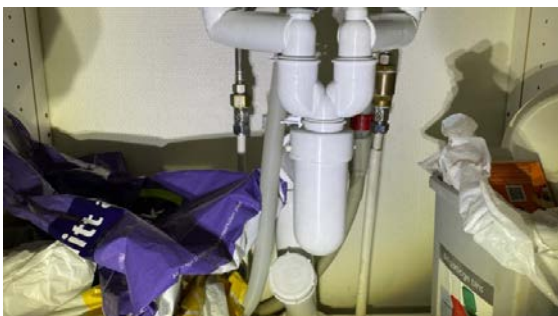
Vannrør av kobber, innvendig hovedstoppekran ble ikke lokalisert ved befarig.
