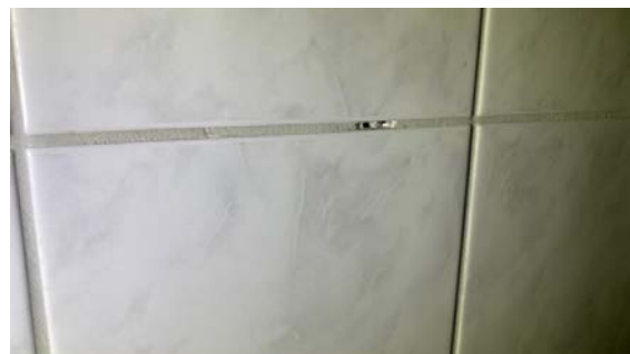
Det er registrert noe sprekker i fuger.
