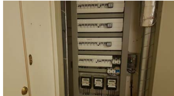
Kontroll av el-skap.
