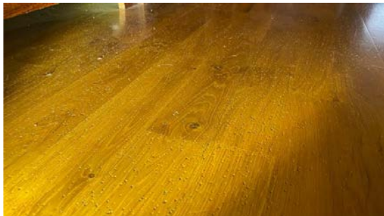
Det er en del hakk/riper i parkett.
