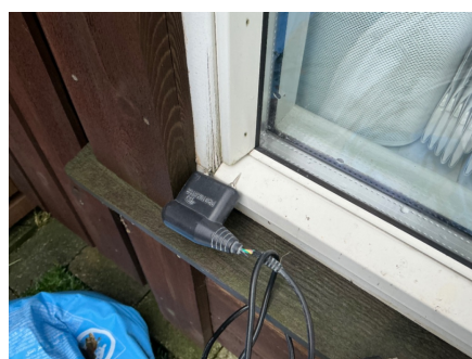
Fukt/råteskade på vindu i stue 1 etasje.
