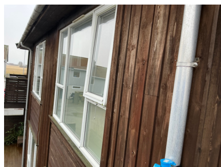
Fukt/råteskade på vindu på soverom 2 etasje.
