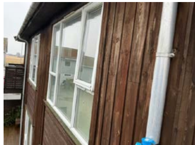
Fukt/råteskade på vindu på soverom 2 etasje.
