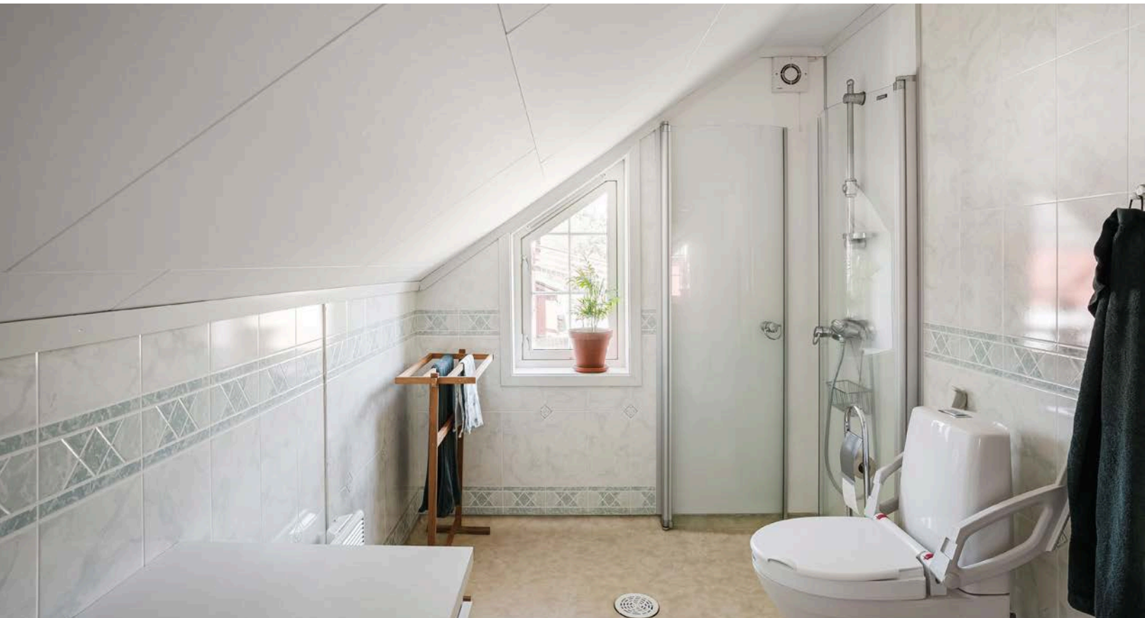
Baderommet har belegg på gulv, våtromsplater på veggene, et lite vindu og mekanisk ventilasjon med ventil på yttervegg.
