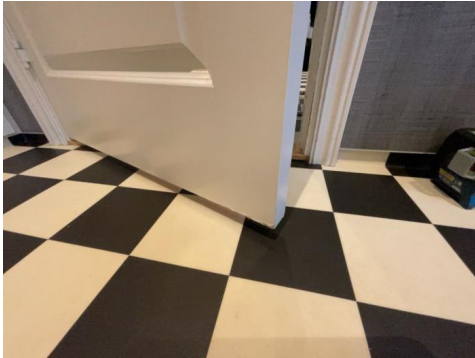
Slitasje på dør til bad/vaskerom og noe overflateslitasje på karm
