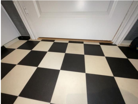
Luftespalte under dør
