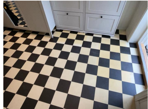
Noe misfarging på belegg i vindfang
