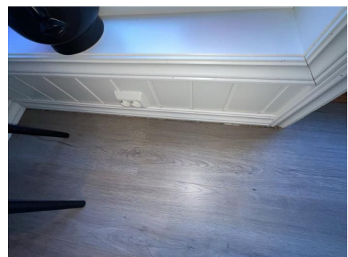
Manglende tilpasning av gulv i utbygg på stue ved verandadør
