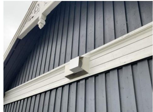
Kombinert avkast og tilluftshette på gavelvegg ved utenfor teknisk rom
