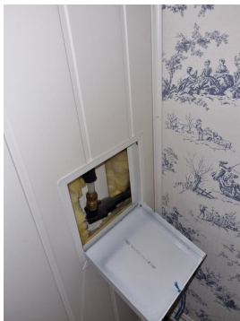
Mangler vannføler i inspeksjonsluke ved utekrane på soverom 1
