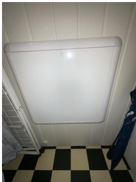
Oversikt vannfordelingskap. Det kan med fordel merkes på utside av dør at hovedstoppekrane er plassert i skap.
