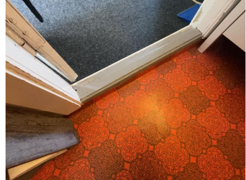
Løst belegg ved dørterskel
