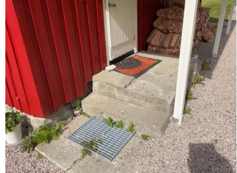
Skader i betong på hovedtrapp
