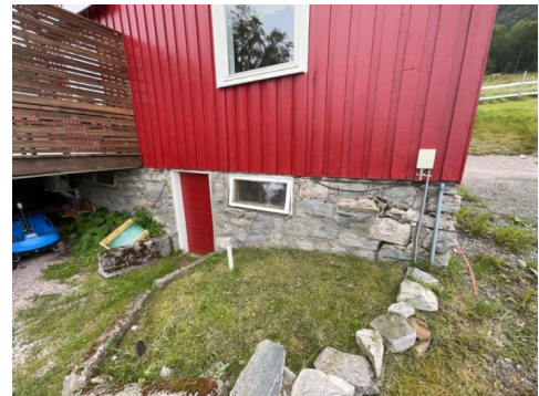
Sprekker i mur mot gavelvegg
