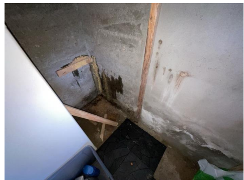
Saltutslag i bakre del av lagerrom 1
