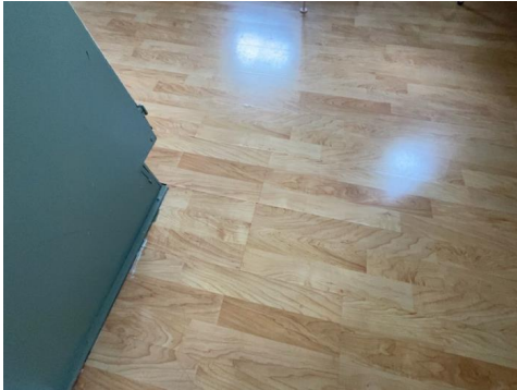
Gulv på kjøkken er slitt/svelleskader i skjøter på laminatgulv. IKK emontert i henhold til leggeanvisning med tanke på forskyvning av skjøter
