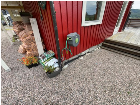
Synlig grunnmursplast, mangler klemplast
