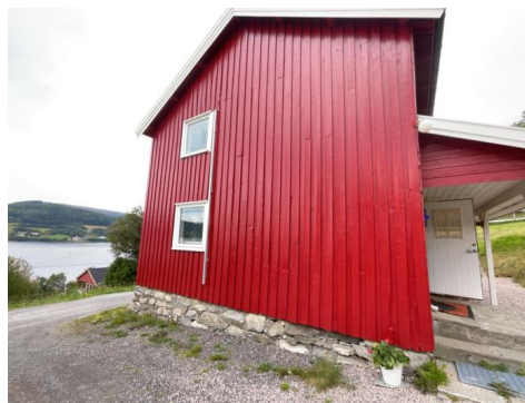
Gavelvegg mot sør/vest som har råteskader i kledning
