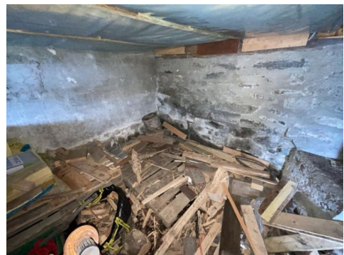
Saltutslag i lagerrom 2
