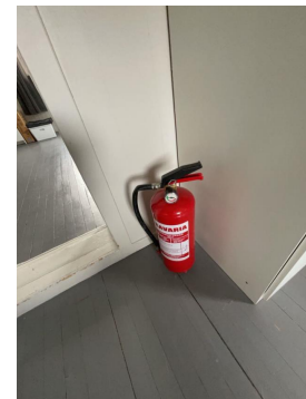
Brannslukker på soverom 3 fra 1988
