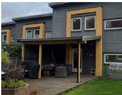
Takoverbygg til terrasse.
