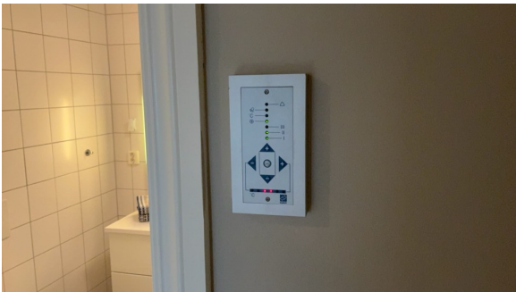
Styringspanel i entre.
