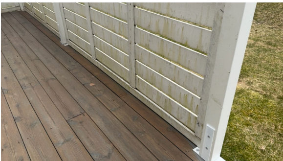
Eksempel på slitasje.
