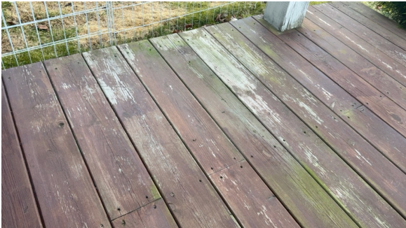
Eksempel på slitasje.
