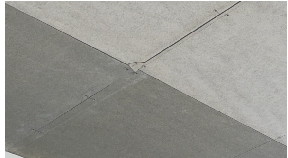
Sprekk i himlingsplate.
