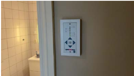
Styringspanel i entre.
