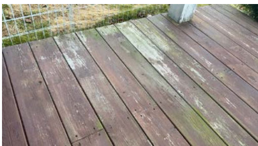
Eksempel på slitasje.
