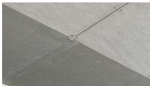
Sprekk i himlingsplate.
