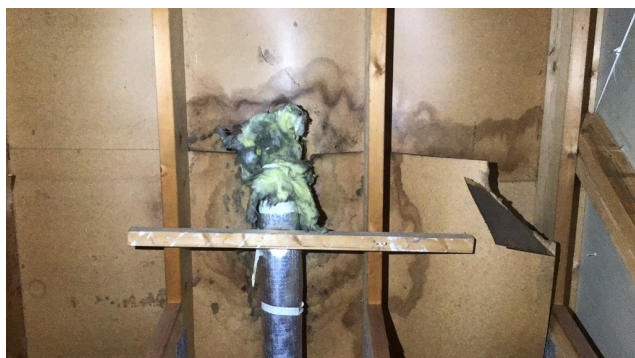
Fukt merker rundt gjennomføringer
