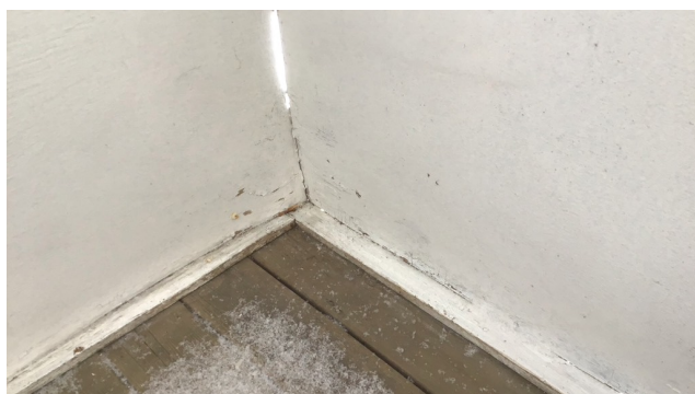
Fukt skader i nedkant plater på rekkverket
