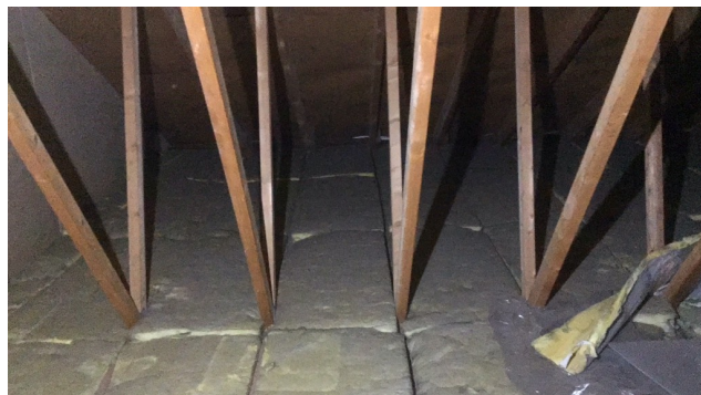
Begrenset tilluft i nedkant tak
