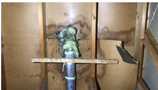
Fukt merker rundt gjennomføringer
