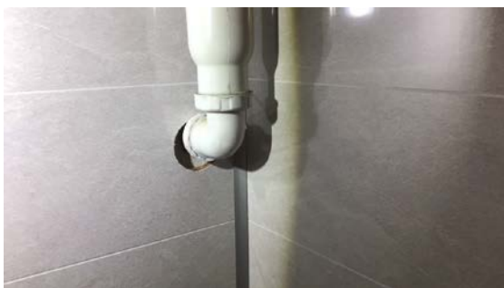
Utettheter rundt rør
