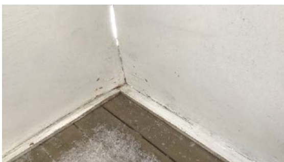
Fukt skader i nedkant plater på rekkverket
