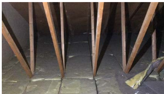
Begrenset tilluft i nedkant tak
