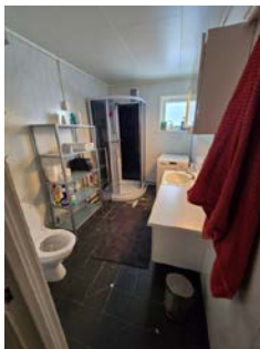
Bildet viser bad som må regnes med oppgraderings behov. Påregne totalrenovering
