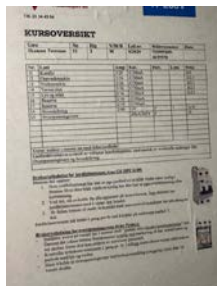
Kursoversikt i sikringsskap Sikringsskap med automatsikringer.
