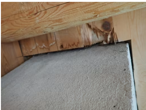
Indikasjon på lekkasjer ved pipe.
