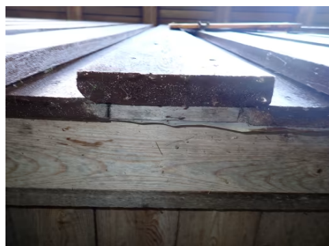
Begrenset/manglende lufting mellom kledning og veggkonstruksjon.
