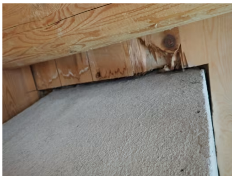
Misfarging i takpanel i overkant av pipe.
