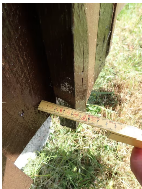
Kledningsbord som ikke tetter mot underligger.
