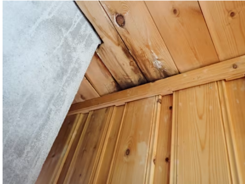
Misfarging i takpanel i nedkant av pipe.
