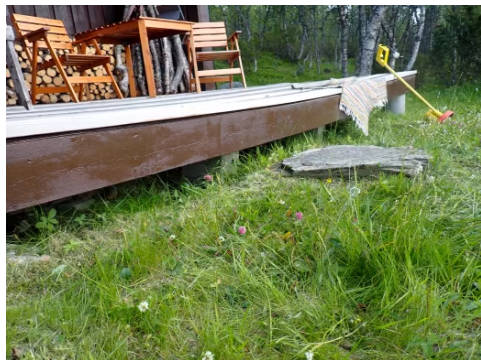
Tydelig skjevhet i konstruksjonen.
