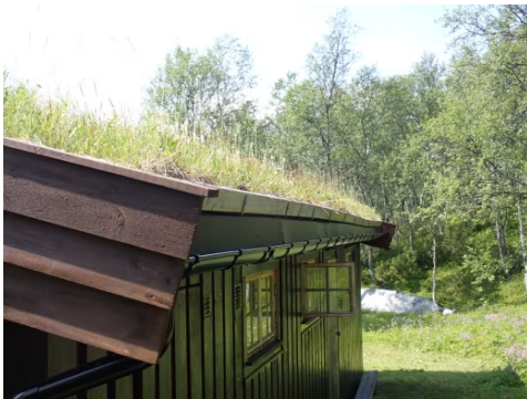
Tydelige svanker ved takfoten.
