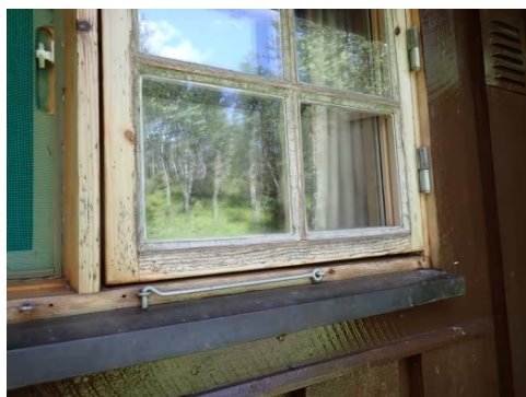
Slitasje/misfarging i vinduskarm.
