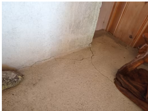
Sprekker i peismur.
