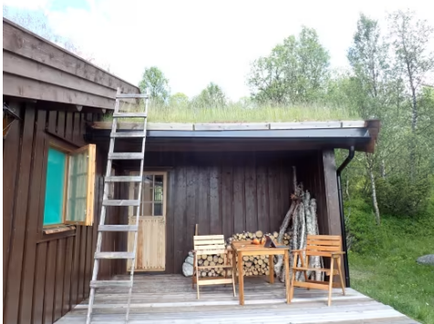
Tydelig nedbøying i konstruksjonen.
