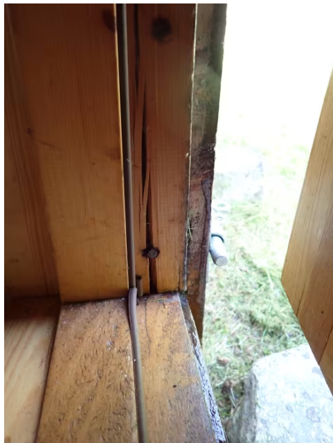
Sprekk i dørkarm.
