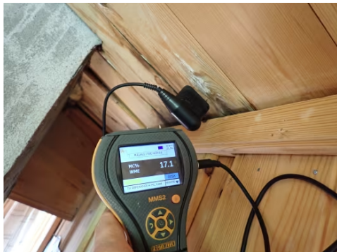
Fuktmålingen indikerer skader.
